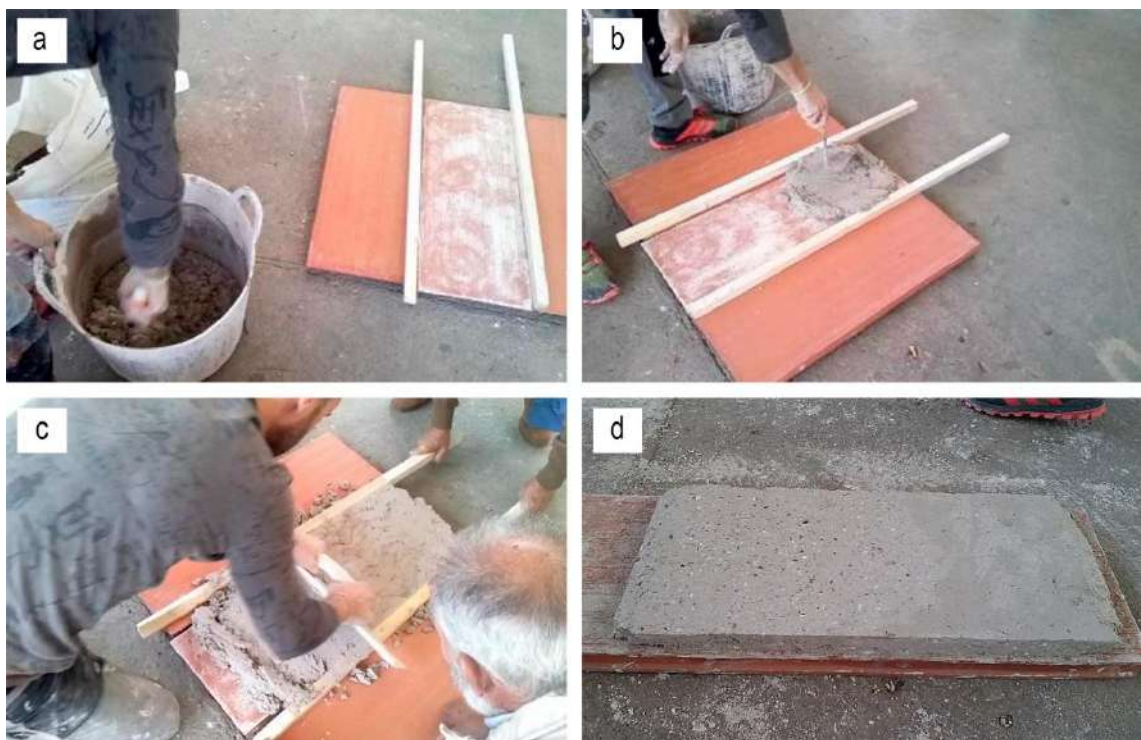
Figura 133. Aplicación en obra de yeso tradicional en superficies horizontales (pavimentos): a) realización de la mezcla agua/yeso; b) y c) aplicación del yeso sobre la superficie; d) resultado de pavimento liso (derecha) y rascado (izquierda).
