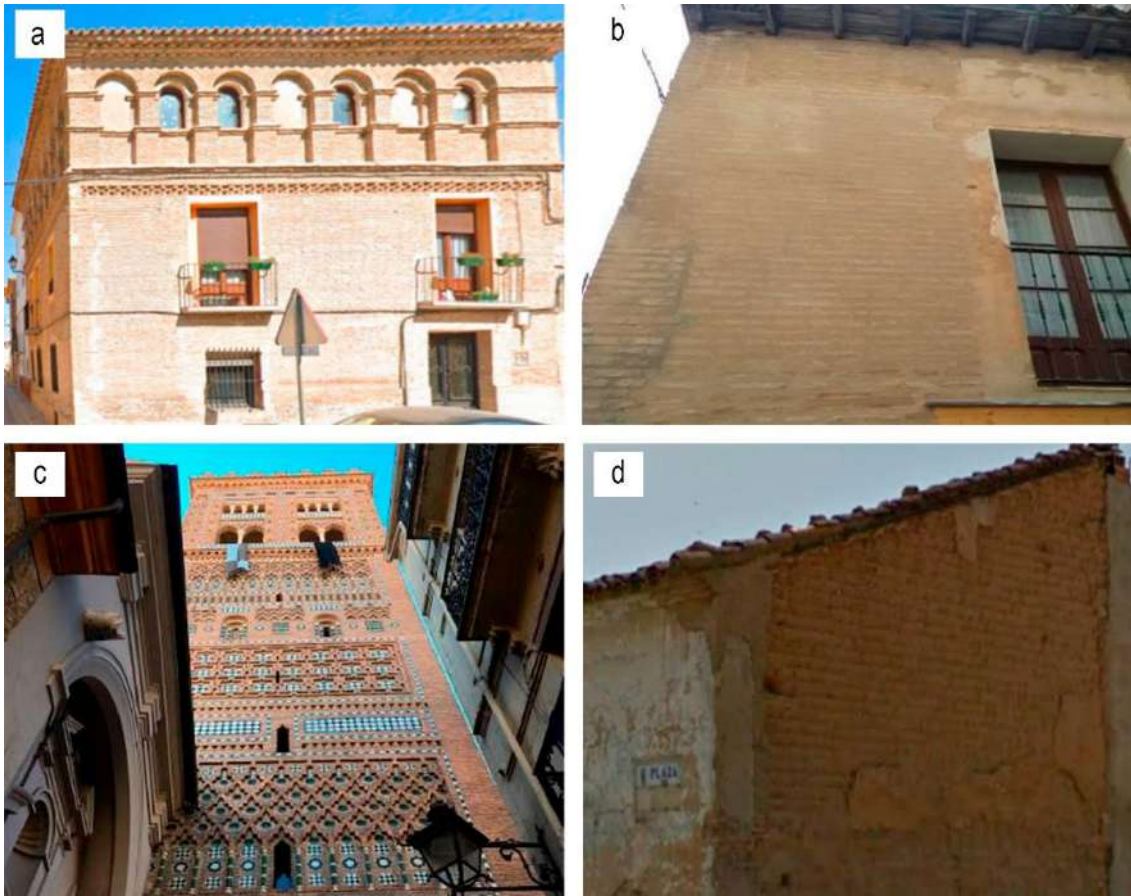
Figura 64. Juntas en muro de ladrillo sin revestimiento en a) Villamayor de Gállego (Zaragoza), b) Huescay c) Teruel, Torre del Salvador (siglo XIV). Juntas en muro de ladrillo con revestimiento en d) Tauste (Zaragoza) Fotografías del autor.
