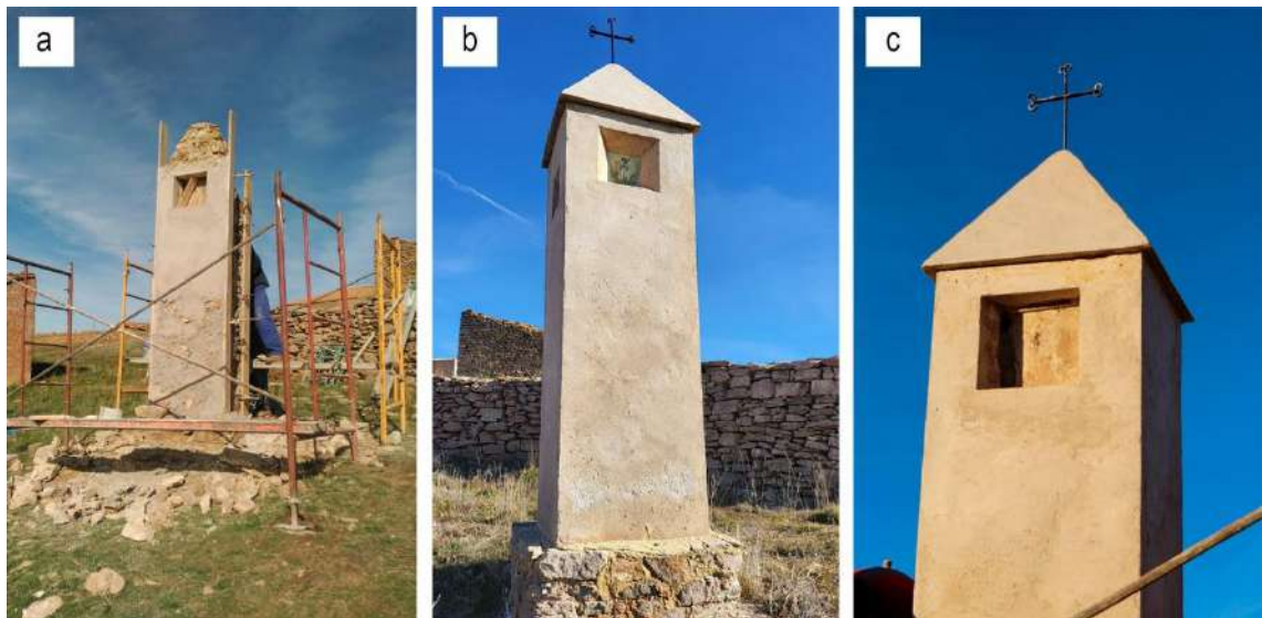
Figura 136. Distintas imágenes del proceso de restauración del peirón de Santa Bárbara: a) avance de las obras de restauración donde se aprecian los regles en las cuatro esquinas para asegurar unas líneas totalmente verticales; b) y c) estado restaurado. Fotografías del autor.
