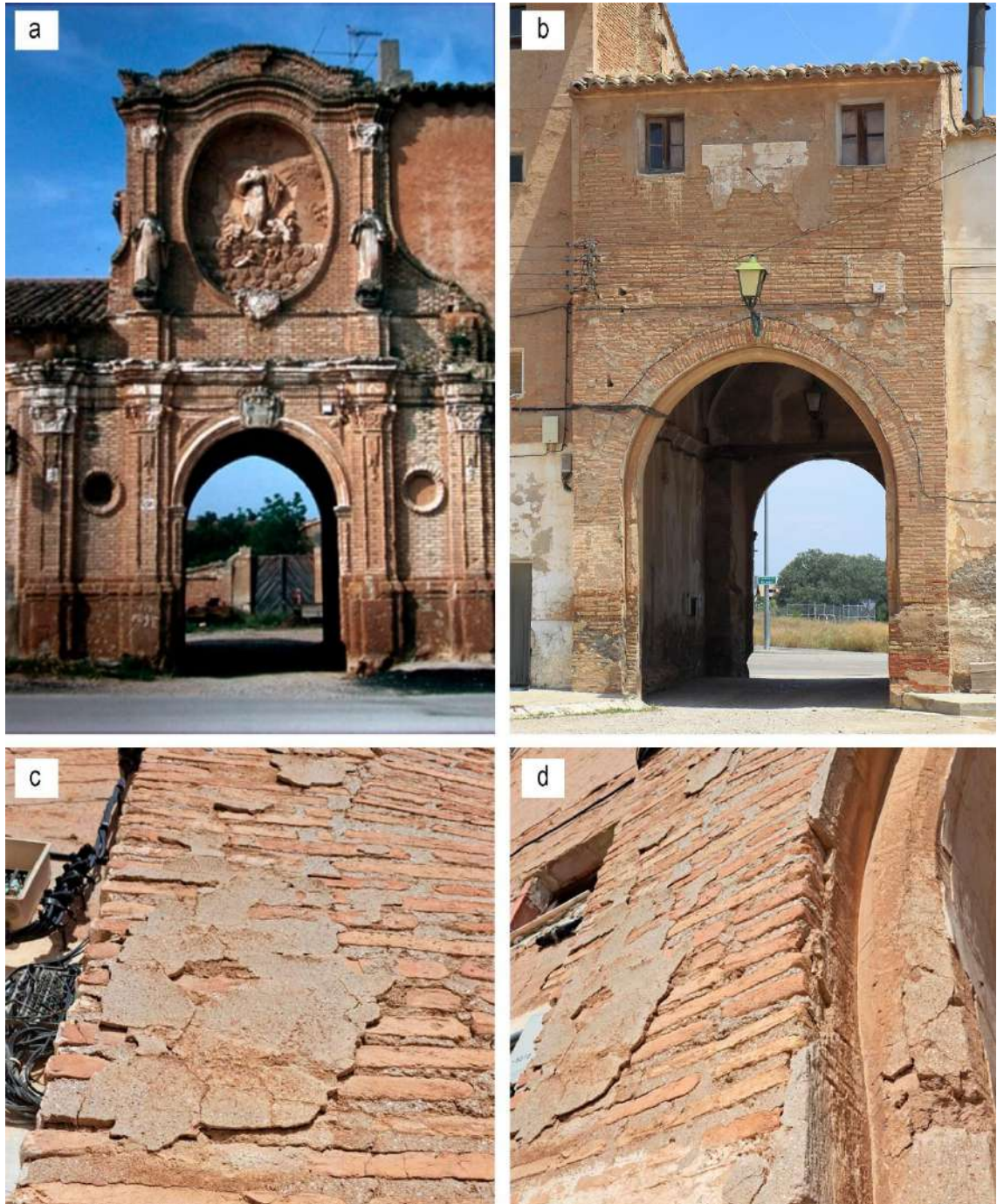
Figura 39. Monasterio de Santa Fe de Huerva: a) fachada delantera de la portada del Monasterio (SIPCA, s.f.); b) - d) fachada trasera de la portada del Monasterio, donde se pueden apreciar restos del revestimiento exterior realizado con yeso. Fotografías del autor.
