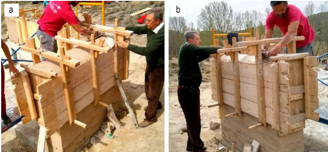
Figura 156. a) y b) Montaje de la segunda altura del encofrado utilizando el mismo sistema tradicional. Fotografías del autor.
