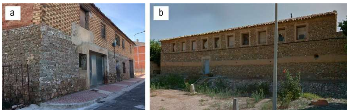
Figura 69. Zócalos en a) Fuentes de Ebro (Zaragoza) y b) Bardallur (Zaragoza). Los muros se realizaban colocando dos hojas de piedra, unidas entre sí mediante capas de yeso y atadas con otras piedras en sentido transversal. Fotografías del autor.
