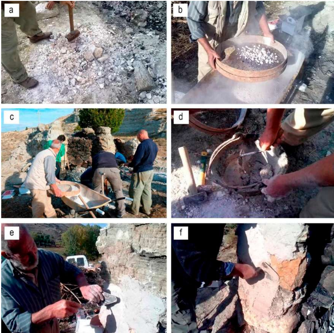
Figura 132. Aplicación de un revoco de yeso en paramentos horizontales (fachada) procedente de las cocciones experimentales, realizada al día siguiente de finalizar la cocción: a) molienda de las piedras de yeso usando una maza; b) y c) cribado utilizando un tamiz; d) amasado del yeso con agua con una proporción orientativa agua/yeso de 0,6; e) aplicación en el paramento del material obtenido en el horno de Navarrete; f) aplicación en el paramento del material obtenido en el horno de Albarracín. Fotografías del autor.
