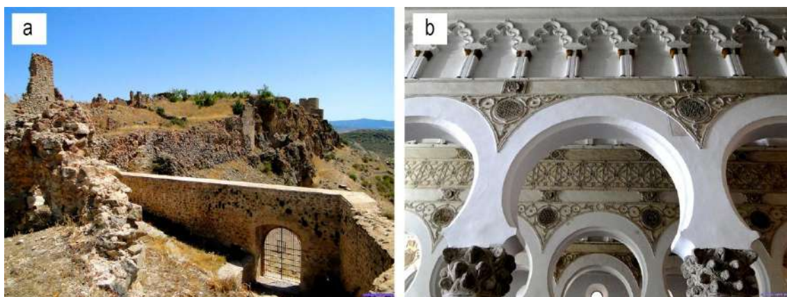
Figura 34. a) Uso de yeso en exterior en las murallas de Moya (Cuenca) según Villanueva Domínguez (2005) (Santiago López-Pastor, 2017); b) yeserías interiores en la Sinagoga de Santa María la Blanca (Toledo) según Villanueva Domínguez (1996) (Santiago López-Pastor, 2014).
