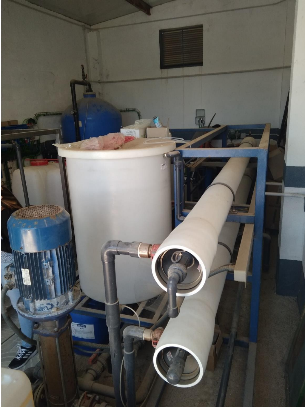
Imagen 4: Planta de osmosis inversa de Torre Cardela
