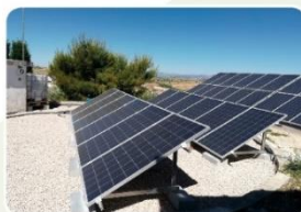
Placas fotovoltaicas y baterías acumuladoras.
