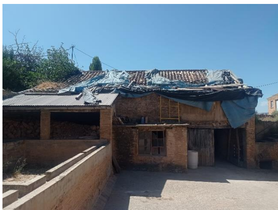
Il. 88. Detalle del tejado del obrador en su estado actual de deterioro. Imagen de autoría propia
