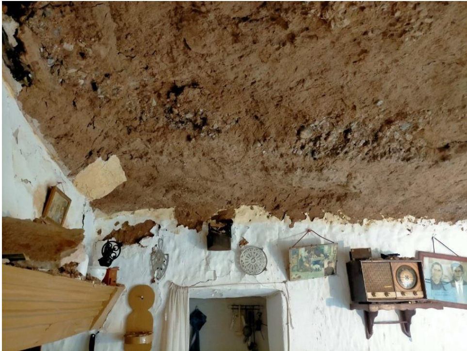
Figura 1. Desprendimiento en techo motivado por la presencia de humedad en el terreno.
