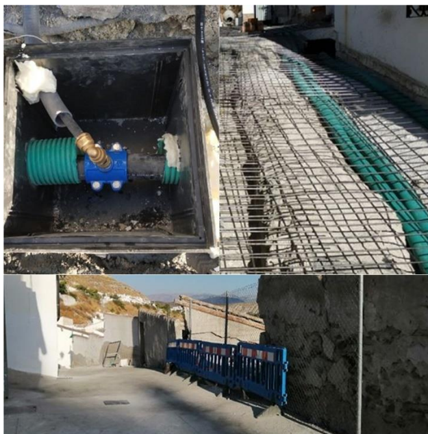
Figura 5. Reposición de servicios en c/San Isidro Alto (superior) y c/San Isidro (inferior).
