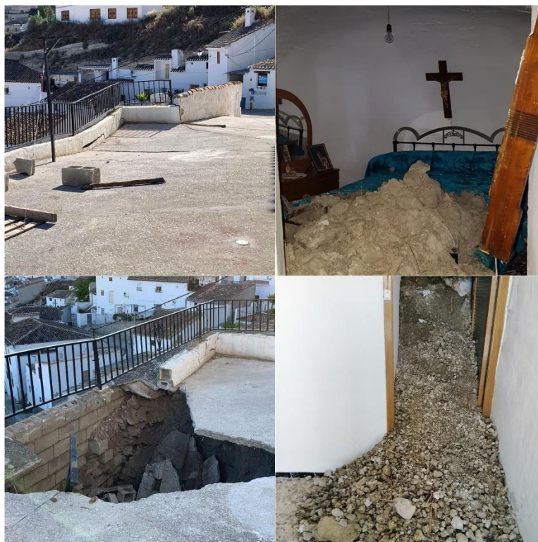
Figura 2. Hundimiento y posterior socavón en c/San Isidro Alto (izquierda) y daños en viviendas bajo vial en c/San Isidro (derecha).
