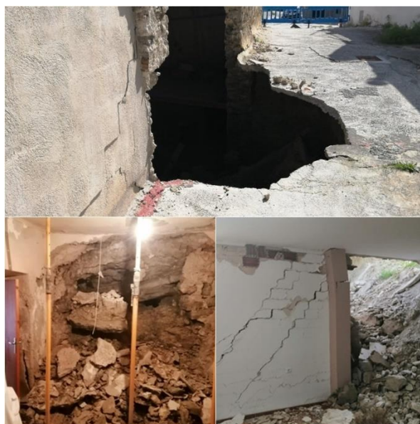
Figura 1. Socavón en c/San Isidro (superior) y daños en viviendas bajo vial en c/Carrera de San Isidro (inferior).
