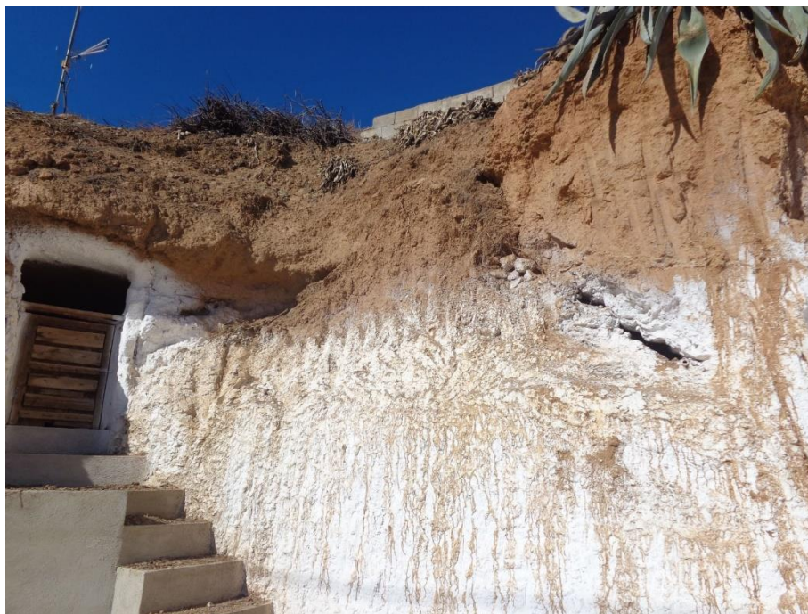
Figura 3. Entrada vivienda-cueva con escasa montera y existencia de discontinuidad en fachada.
