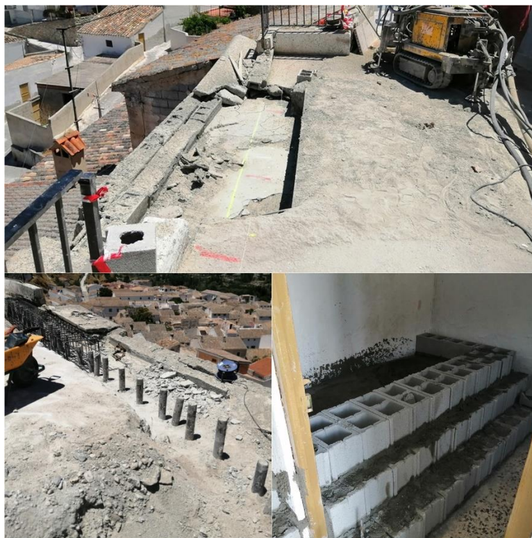
Figura 3. Trabajos de reparación de socavón en c/San Isidro Alta (superior izquierda) y muro de contención en habitaciones en c/San Isidro (inferior derecha).
