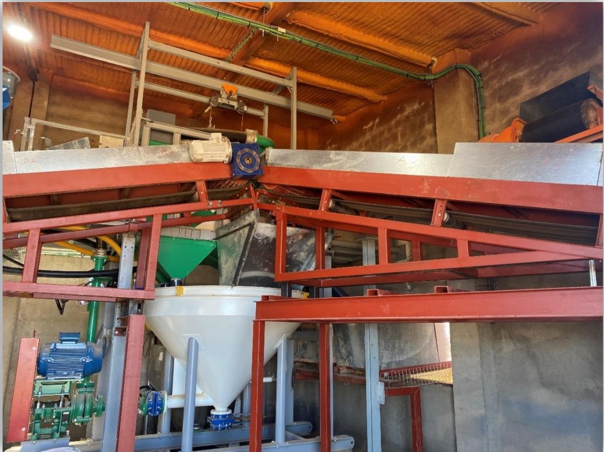
Figura 2.23 Planta compacta. Fuente:AMP
