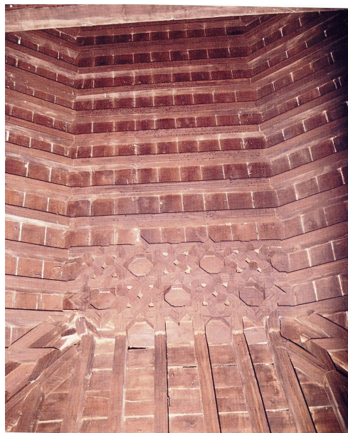
Armadura de madera del hospital de Iznalloz, reconvertido en almacén del diezmo (S. XVI)
