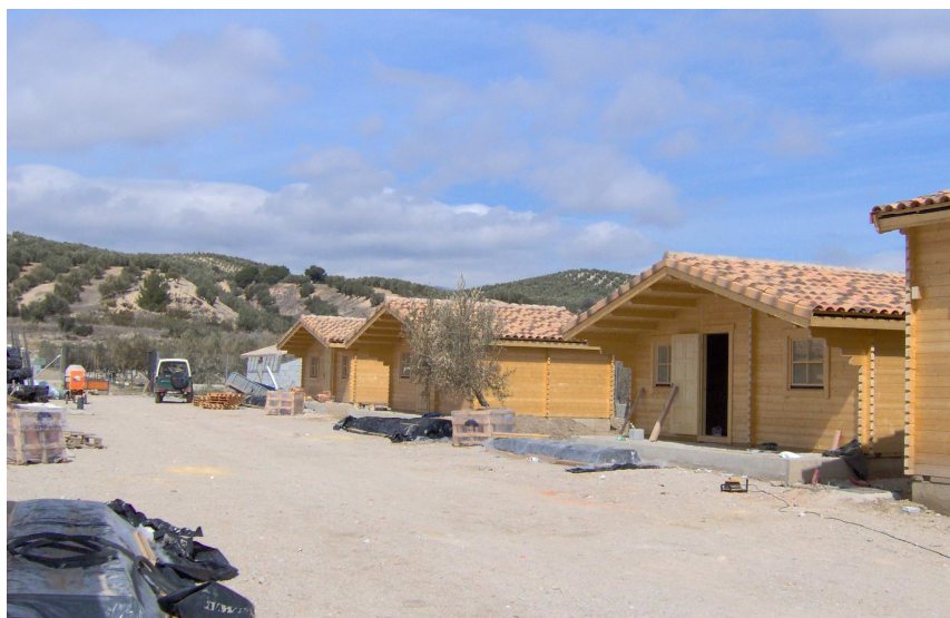
Instalación de bungalows de madera en la iniciativa de alojamiento rural “Caserío de la Fuente”, Deifontes.
