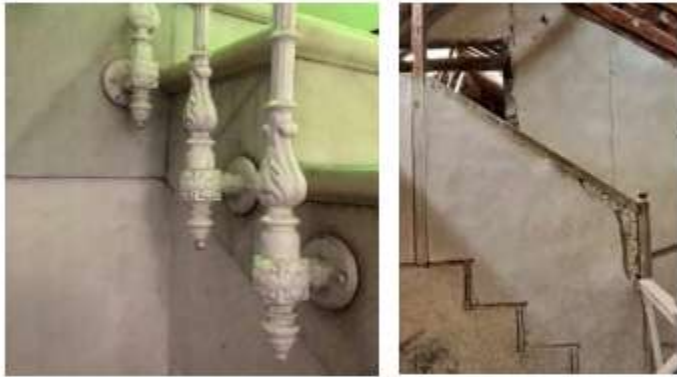
Fig.- II.53. Piezas de cogida de fundición de hierro de la escalera principal.
