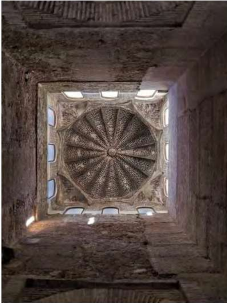
Fig.- I.27. Vista interior cenital de la cúpula de gallones de la qubba de la puerta de la Rawda.
