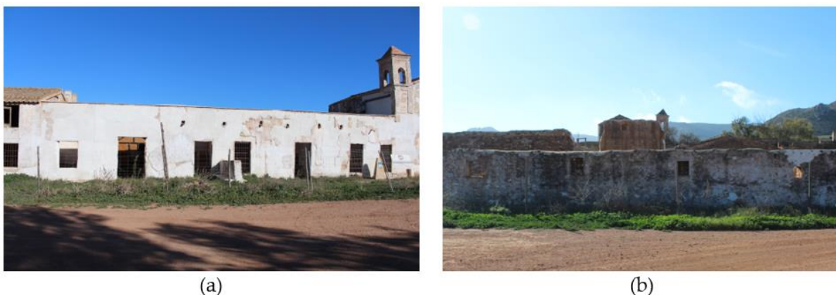
Fig 30. Cortijo del Fraile en Níjar. (a) Fachada suroeste con huecos de grandes dimensiones en puertas y ventanas. (b) Fachada noreste con ventanas poco numerosas y de dimensiones reducidas.
