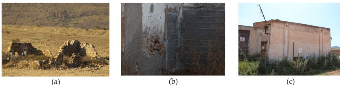
Fig. 25. (a) Aparejo de muro de la ruina del Cortijo Segura (Níjar), de mampuestos de piedra caliza y mortero de cal. (b) Encuentro de muro de bloque de hormigón con muro de mampostería, en el que se encuentra el hueco de una puerta macizada también con bloque de hormigón. (c) Centro de transformación del Cortijo del Fraile, con muros de ladrillo con mortero de cemento. Fotografías de la autora, 2020.
