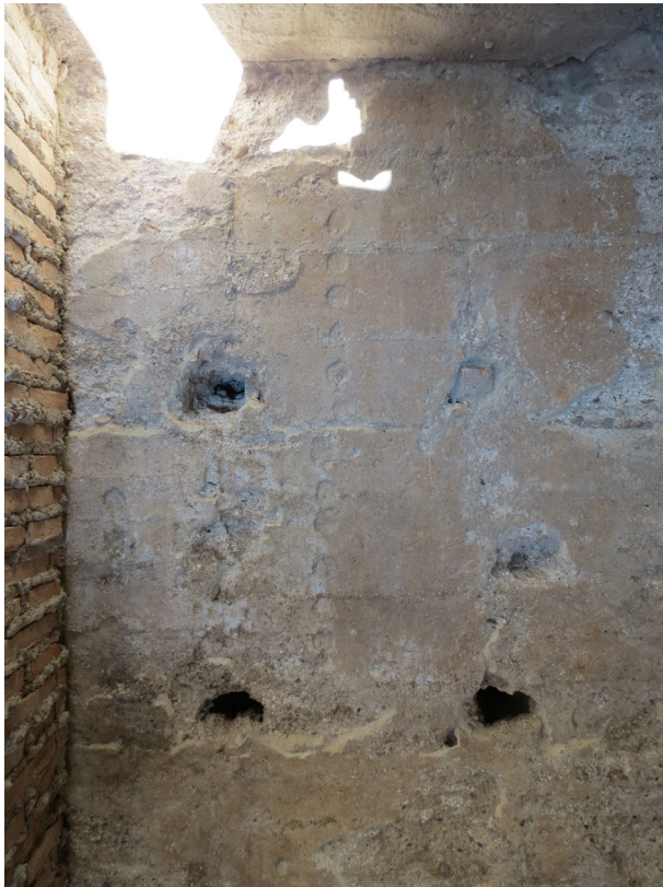
Fig. 2 - Impronta de maderas y clavos del encofrado.
