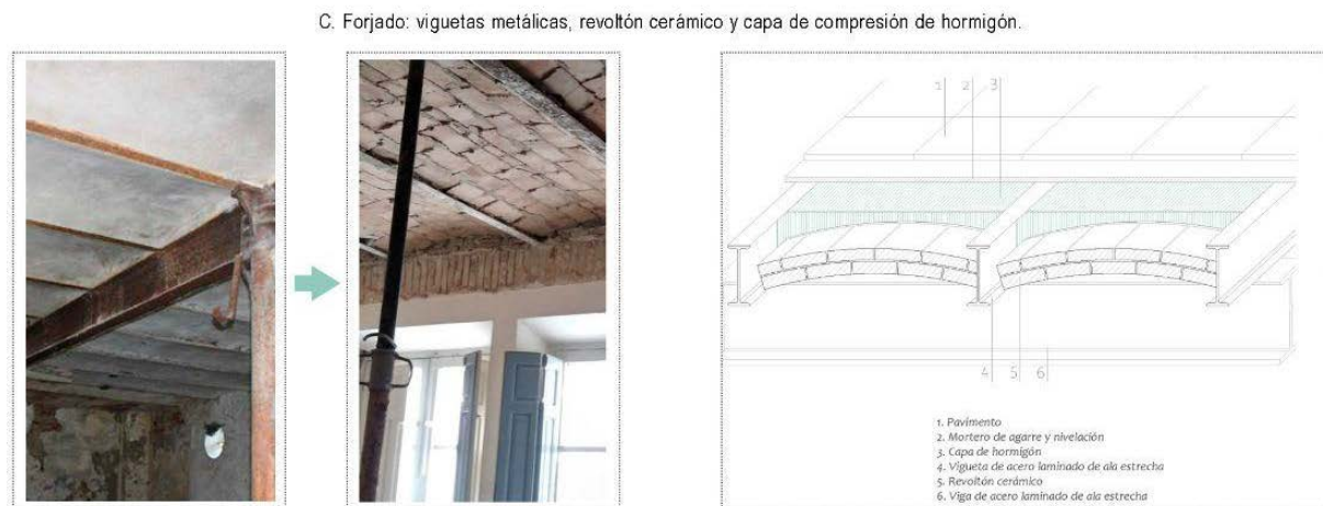
Figura 8: Comparativa del detalle C con referencia a la Azucarera Nuestro Señor de la Salud (Fotografía Beatriz Castilla). Caso de forjado de viguetas metálicas, revoltón cerámico y capa de compresión. Fuente: elaboración propia.
