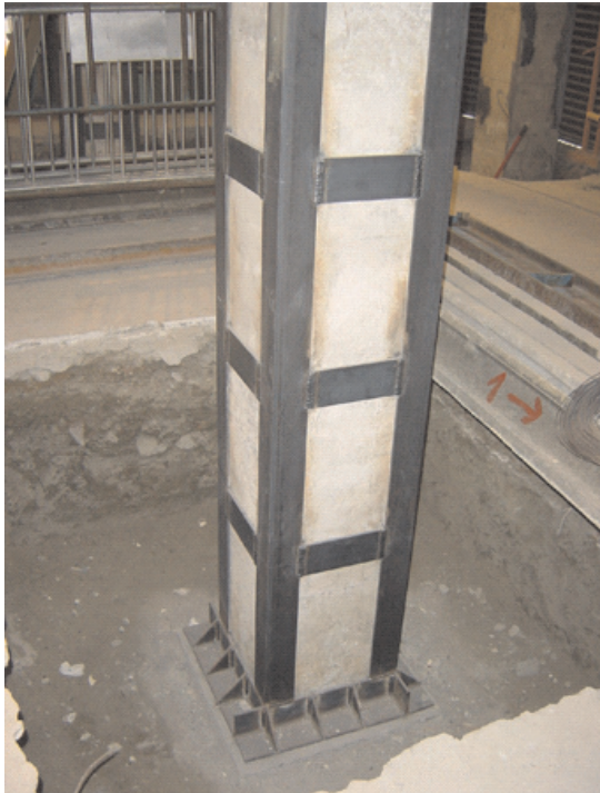
IMAGEN 3. Refuerzo activo de soporte de hormigón armado, ejecutado con angulares y presillas de acero laminado sobre cerco del mismo material nivelado en cara superior de la zapata.
