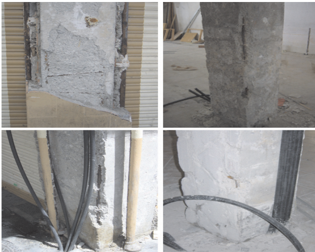
IMAGEN 2. Patología por corrosión de armadura con descantillamiento de revestimiento. Se manifiesta la baja calidad del hormigón con disgregación profunda y pandeo y separación de armadura por compresión.
