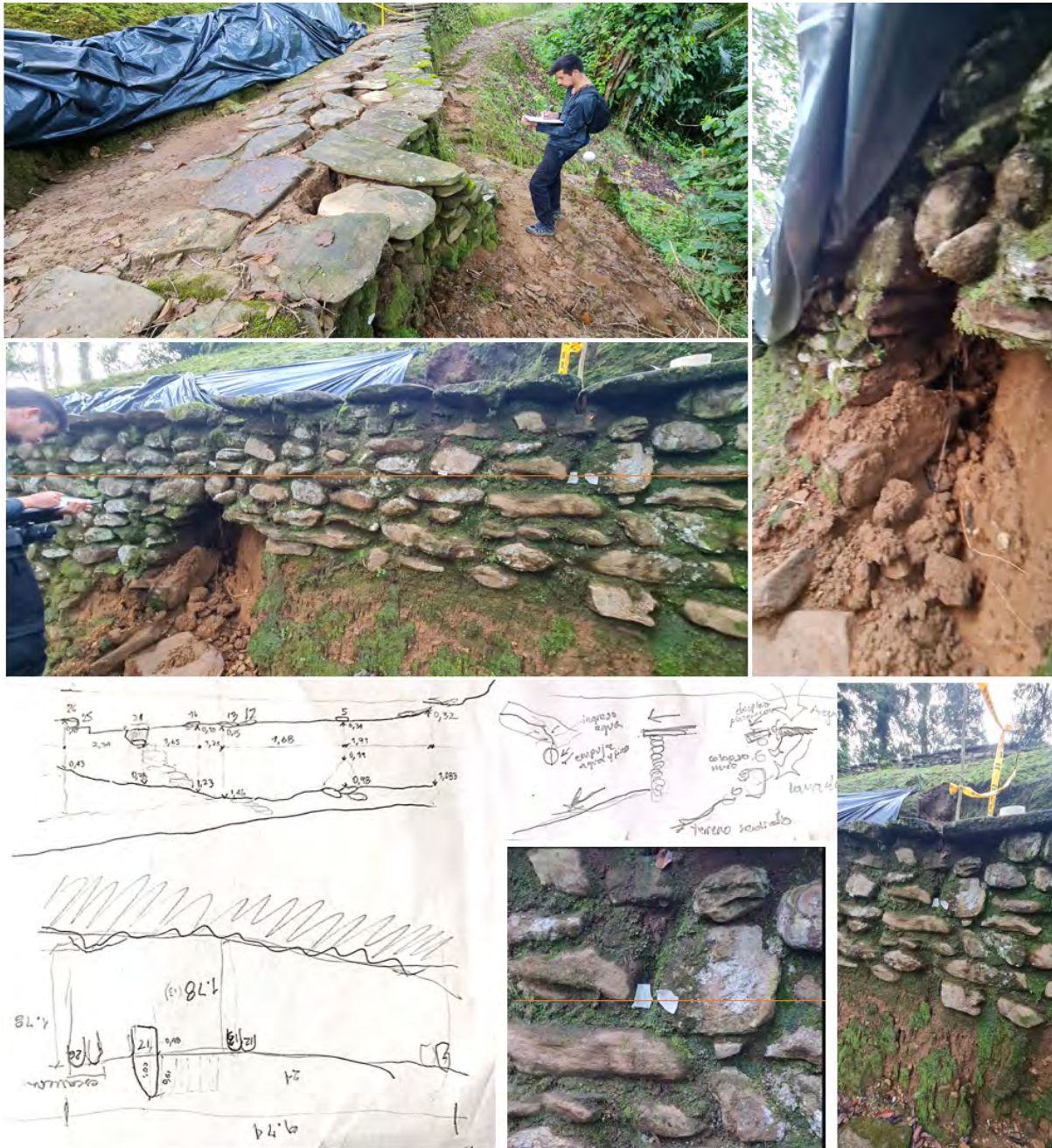
Figura 47. Registro de medidas y niveles del sector colapsado del muro occidental terraza 52 (uv50). Fotografías: M.I. Mayorga, 2022.
