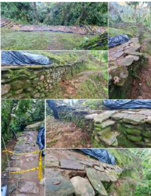
Figura 40. Registro del muro colapsado costado occidental terraza 52. Fotografías: M.I. Mayorga, 2022.
