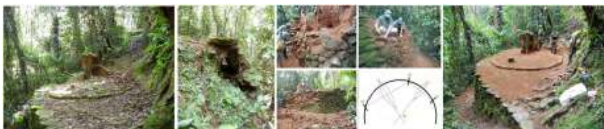
Figura 130. Proceso de intervención, muro del anillo (terrace) 65, estado inicial y colapso, intervención y geometría para buscar el centro del anillo y el estado final. Mazuera 2014.
