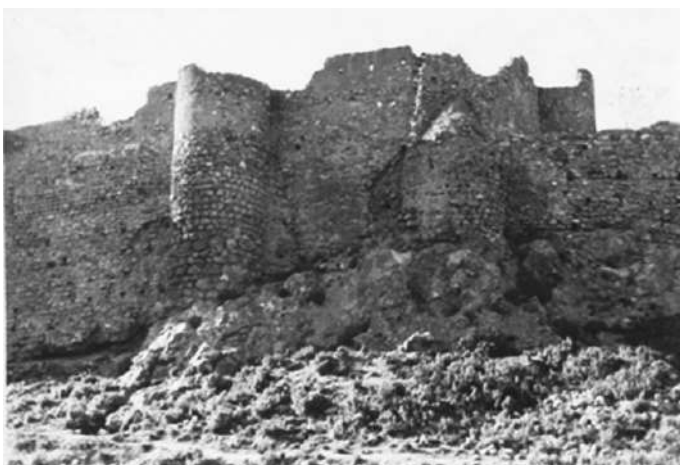
Fig. 12. Onda. Muralla oriental de la alcazaba en torno a 1950. Vista de la antigua puerta monumental con sus torres de flanqueo. La fotografía permite observar la reparación en forma de V que se hizo de la muralla tras el colapso de la puerta.
