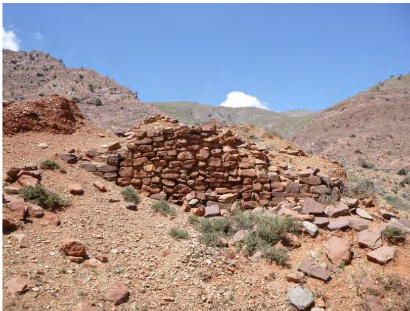
Fig. 16. Acceso S. Parte exterior de la Puerta de Tinmal. Se observa cómo este se ha cegado con mampuestos de los derrumbes (Sarr & Mattei, 2019).
