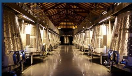
Img. 155. RM 8/50. Bodega Quinta do Castro 954 .
