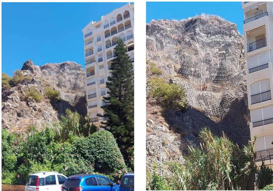
Figura 84. Imagen del detalle de malla para retener los desprendimientos de ladera en la playa Puerta del Mar en la Herradura (Almuñécar). Fotografía de la autora.
