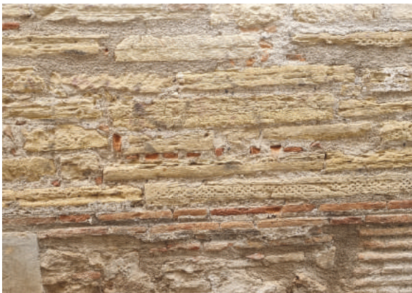
Muro de Rodrigo del Campo donde podemos apreciar materiales de acarreo como son las macabrillas
