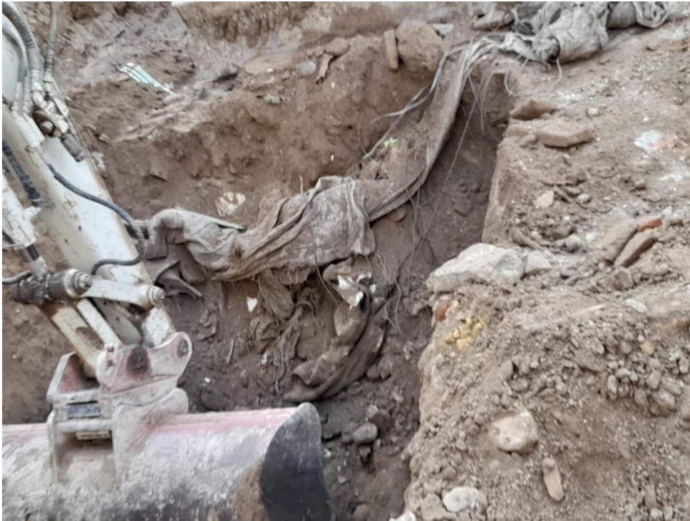
Figura 67 Detalle de la bolsa de escombros
