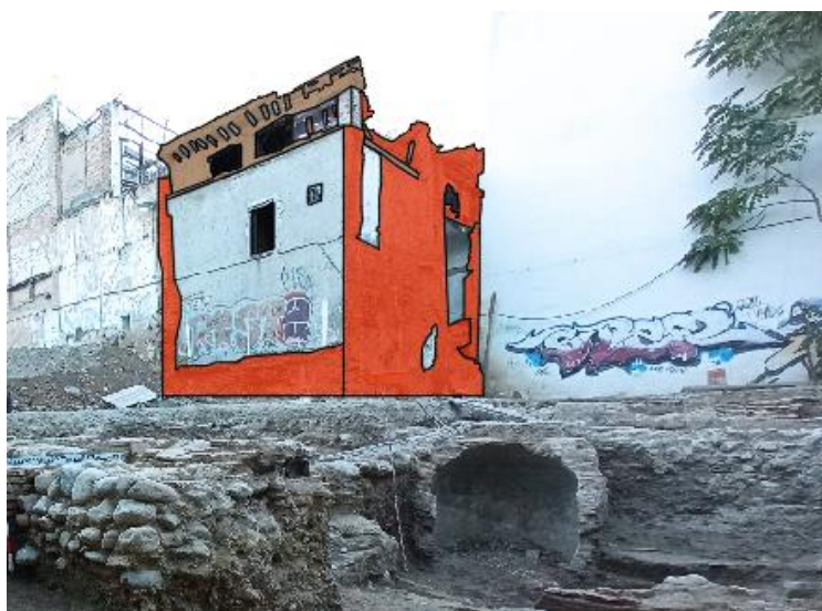
Figura 21 Edificio colindante con riesgo de derrumbe
