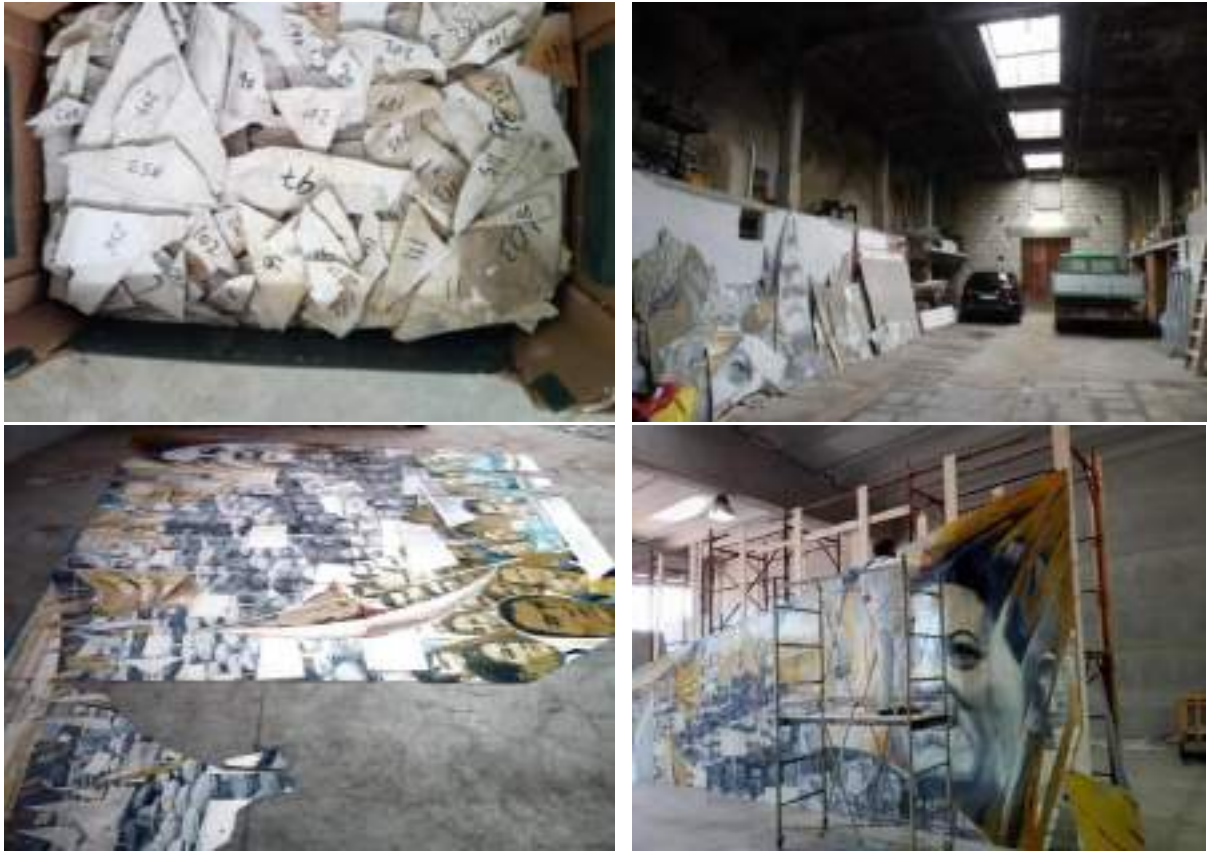
Fig. 448-451 Operaciones de restauración de la obra de Cerignola: recuperación y numeración de fragmentos de paneles, reconstrucción en el suelo y montaje en andamios.
