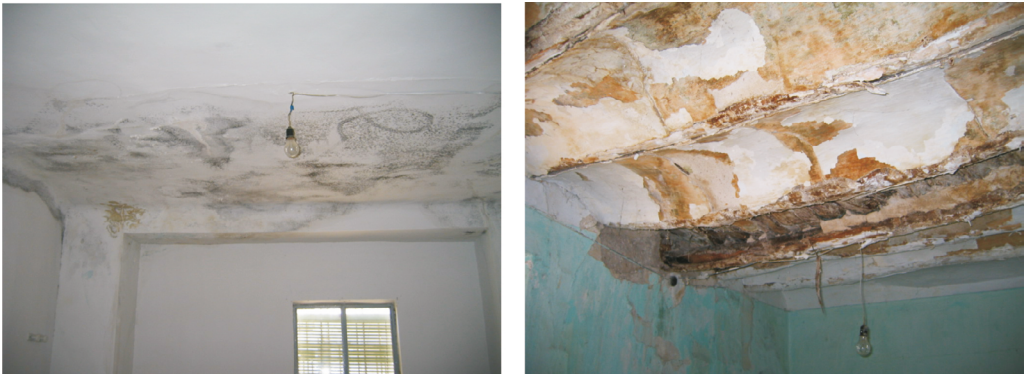
Figura 5: Problemas de humedades bajo cubierta. (Fotografías de María del Carmen Vilchez Lara).
