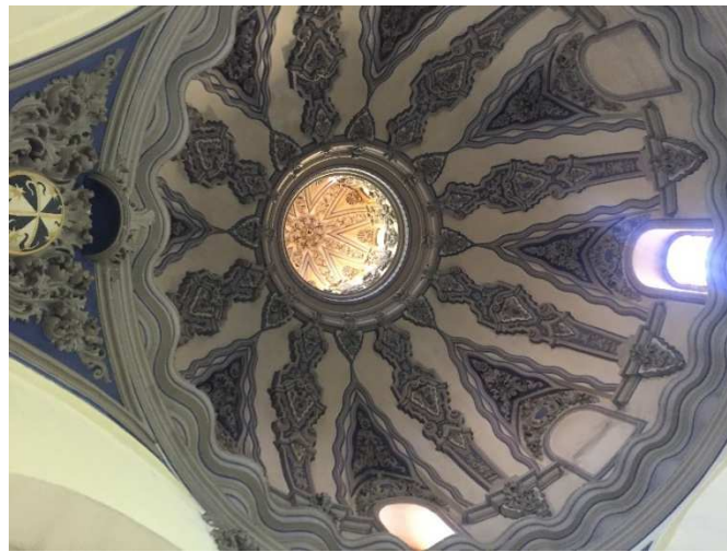
Cúpula del despacho de la jefatura de la Unidad de la Familia y la Mujer en segunda planta
