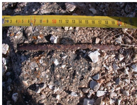
fig. 450.- Armadura con barra de acero liso en la cubierta del nido de ametralladora, posición republicana Atalaya 4. Fidel Baena.
