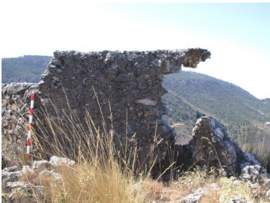
fig. 137.- Muro parapeto afectado por la erosión del terreno que ha provocado el descalce y derrumbe consiguiente, posición rebelde "Portichuelo". Fidel Baena.
