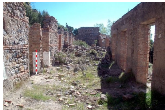
fig. 270.- Ruinas del Sanatorio de la Alfaguara, antes de la intervención de consolidación de 2021. Fidel Baena.
