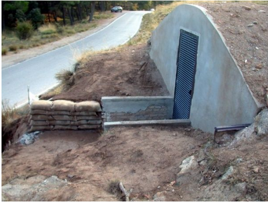
fig. 377.- Fachada del albergue de mando del campamento rebelde "Cuartel de José Antonio", tras la intervención de 2019. Fidel Baena.
