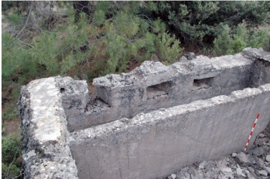
fig. 139.- Estructura habitacional y de combate, construida con muros de hormigón incluso con armadura el muro divisorio, posición "Los Pocicos). Fidel Baena.
