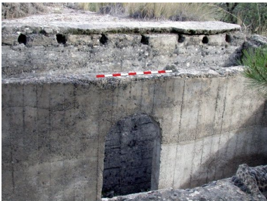
fig. 152.- Estructura habitacional con la cubierta desaparecida, siendo visibles los apoyos de los pares en la coronación del muro, sobre los que se disponía una tablazón, posición rebelde "Alonso" 27. Fidel Baena.
