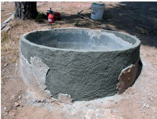
fig. 379.- Depósito de agua del campamento rebelde "Cuartel de José Antonio", tras la intervención de 2019. Fidel Baena.
