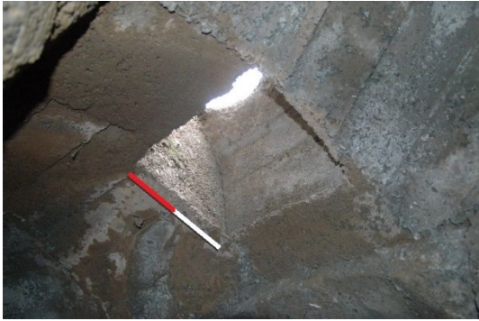
fig. 328.- Tragaluz en la bóveda de la trinchera cubierta, posición rebelde “Alonso” 26. Fidel Baena.
