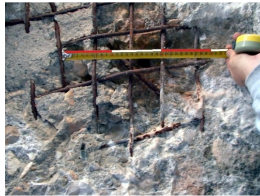
fig. 394.- Armadura de barra de acero liso tejido en la cubierta del nido de ametralladora de la posición rebelde “Puerto Lobo”. Fidel Baena.
