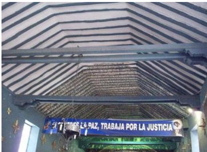
Fig. 100. Charpente sur la nef de l'église Santa Bárbara à Tunja (1609). Photo : Ivan Tunja, 2012. CC BY-SA 3.0 https://commons.wikimedia.org/wiki/File:SANTA_BARBARA_SAN_IGNACIO_TUNJA_2.jpg
