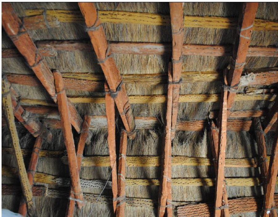
Fig. 75. Charpente de l'église de Salinas de Garcí y Quillacas en Bolivie (Fin XVII e siècle ; Reconstruction 1990). Notez l'utilisation de cordes en cuir d'animal à chaque croisement de poutres (Cactus Cardon). De plus, cette charpente est de type hybride parce qu'elle possède des ciseaux à l'andine que des entrails retroussés à l'ibérique. Philipp Schauer et Teresa Gisbert, Guía turística de iglesias rurales, La Paz y Oruro (La Paz : Editorial Gisbert, 2010), 29.
