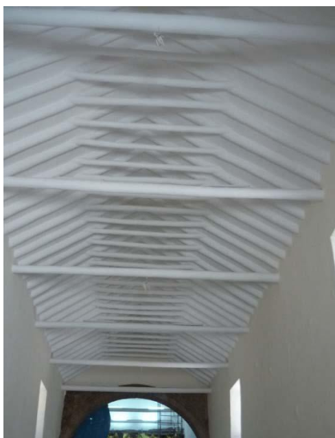
Fig. 23. Charpente de l'église Santa María Magdalena à Taray au Pérou (Réhabilitation, 2017) (Photo : Yoshimi Esquivel, 2011 CC-BY-NC-ND, dans Sistemas de refuerzo estructural en monumentos históricos de la Región Cusco » (Mémoire de master, Lima, Pontificia Universidad Católica del Perú, 2011, 53).
