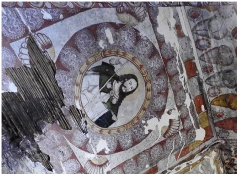
Fig. 51. Détail de la charpente de la nef de l'église San Francisco de Asís à Marcapata au Pérou. Sous la couche picturale largement dégradée s'aperçoivent le treillage et la boue sèche. Photo : José Carbonell, 2021.
