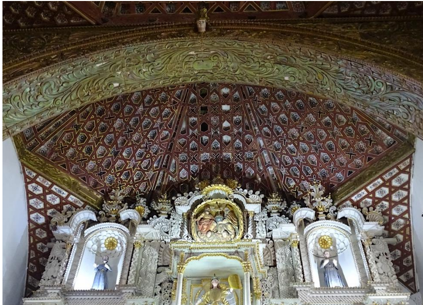
Fig. 20. Charpente sur le chœur de l'église San Miguel à Sucre (Début XVII e siècle) (Photo : Francisco Mamani, 2018).
