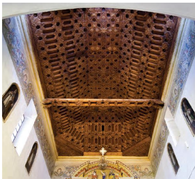
Fig. 120. Charpente à entrelacs sur le chœur de l'église San Diego à Quito (Début du XVII e siècle). Notez dans les coins le pan triangulaire remplaçant les chevrons d'arêtier double. Alexandra Kennedy-Troya et Alfonso Ortiz, Recoleta de San Diego de Quito. Historia y Restauración , (Quito : Fonsal, 2004), 324.
