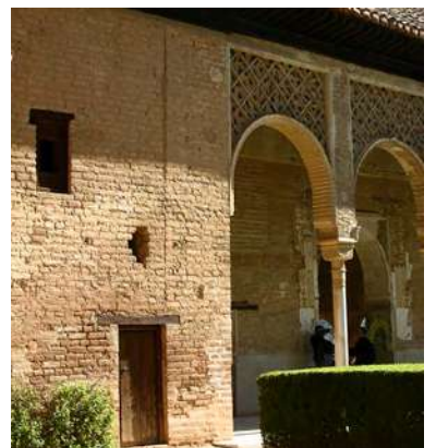
[Fig. 1] Torreón en el pabellón norte del Partal. Junta vertical que denota su adición posterior y actual puerta de entrada al núcleo de escalera. Fotografía de la autora, 2018.
