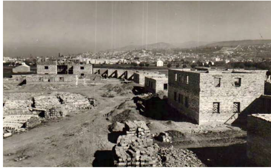
[Fig. 6] Fase 3 de la Barriada de Santa Adela en construcción. Los bloques que aparecen en la fotografía son las viviendas sociales de Carlos Pfeifer. Al fondo, la ciudad. ASGG.
