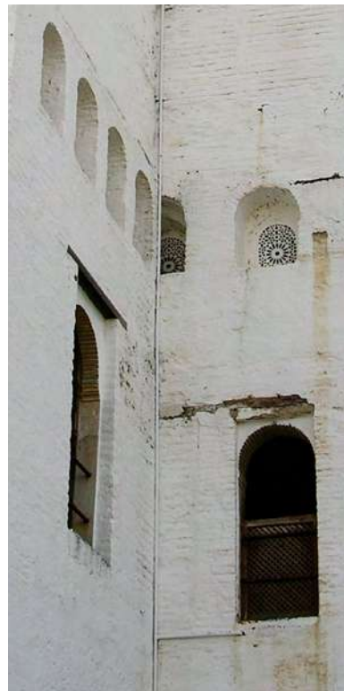
[Fig. 5] Arriba, alzado norte del palacio del Generalife; abajo, detalle del exterior del Mirador en su encuentro con los huecos del Salón Regio. Fotografías de la autora, 2018.
