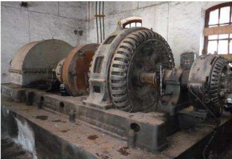
Figura 9. Turbina y Generador. Fuente: Fotografía del autor.
