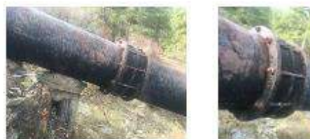
Tubería forzada de Alhóri I. Imagen del autor
