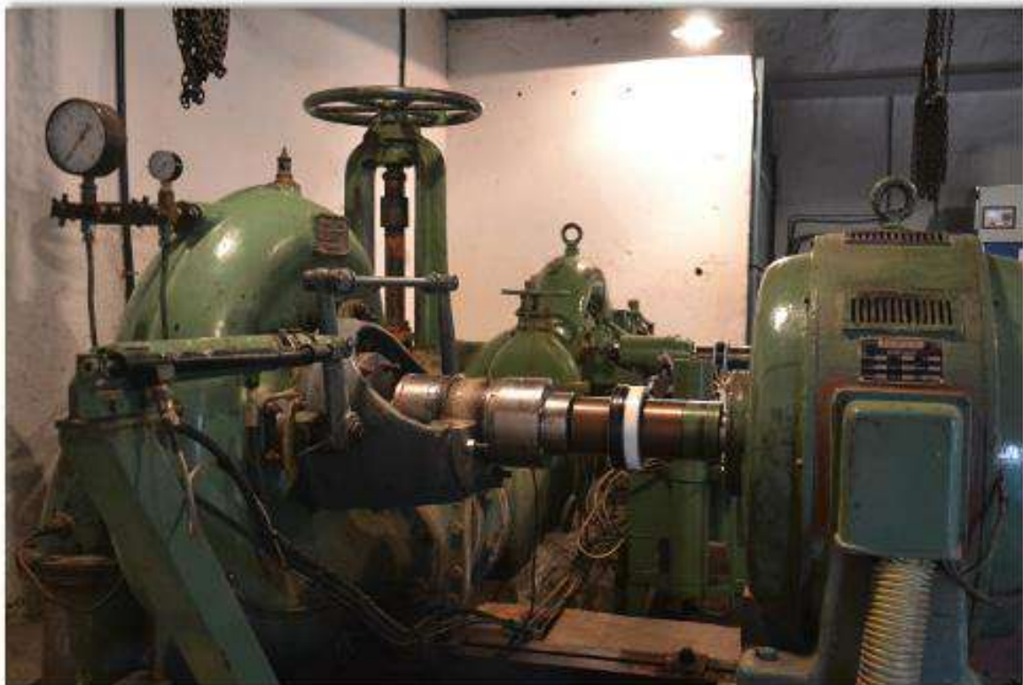
Figura 112. Eje de acoplamiento turbina y generador. Fuente: Fotografía del autor.
