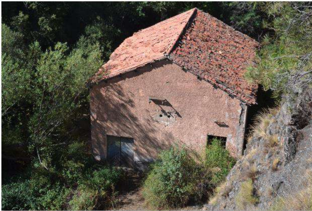
Figura 103. Casa de Máquinas Alhorí II. Fuente: Fotografía del autor.
