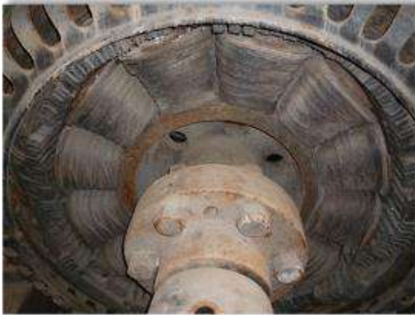
Figura 79: Rotor del generador. Doce polos Fuente: Fotografía del autor
