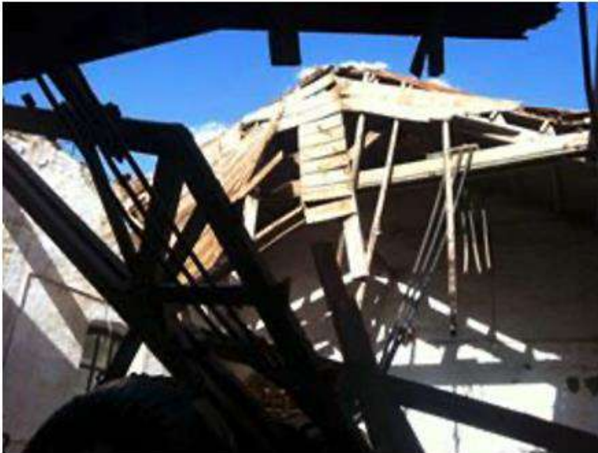
Figura 10. Techo de la casa de Máquinas de la central Alhorí, año 2016. Fuente: Fotografía del autor.
