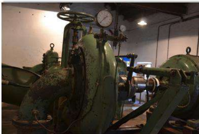
Figura 28. Generadores y turbinas de la central, fabricados en 1924. Fuente: Fotografía del autor.
