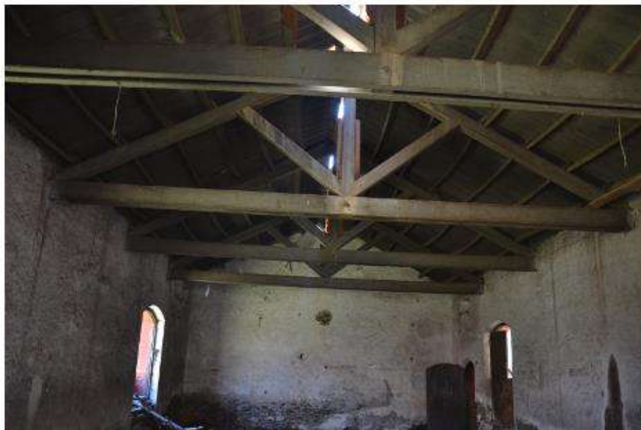
Figura 74. Interior Casa de Máquinas.
