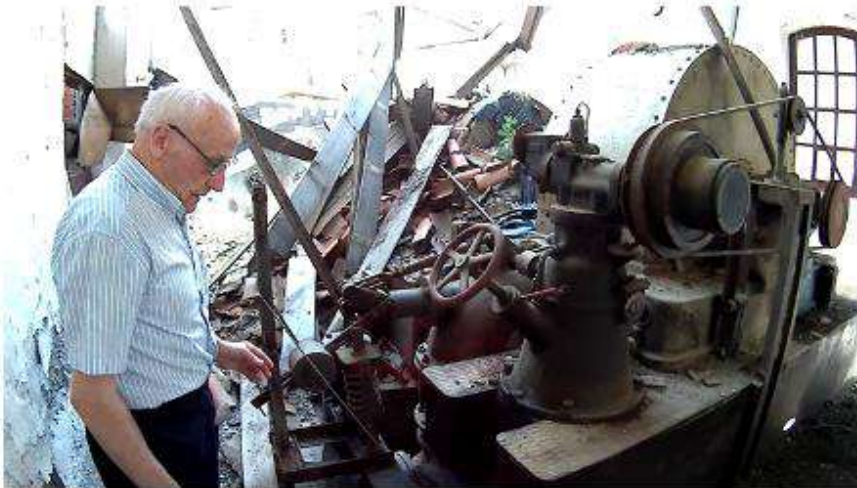
Figura 11. Juan Hidalgo "El Rubio" antiguo Maquinista de la Centra. Maquinaria de la central Alhorí, año 2016. Fuente: Fotografía del autor.
