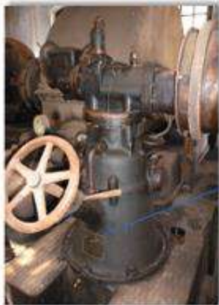
Regulador de la turbina. Fotografía del autor año 2012.
