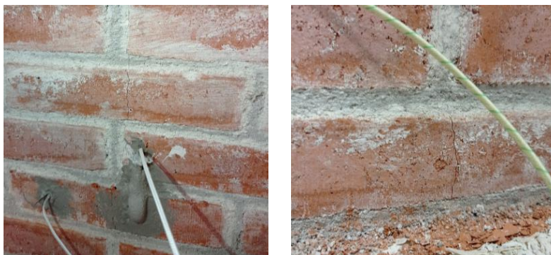
Figura 8. Fisuración observada en los paneles de mampostería tras su exposición a 600 °C.
