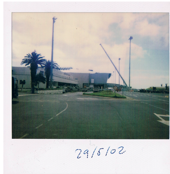
Terminal actual en construcción y terminal de 1968 aún con las escaleras de fachada, 2002. Fot.:Óscar Martínez. Archivo del Aeropuerto de Tenerife Norte.
