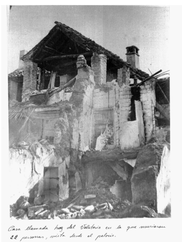
Imagen 5. Edificio derrumbado por el terremoto
