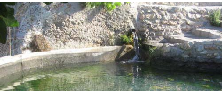
Imagen 24. Entrada de agua
