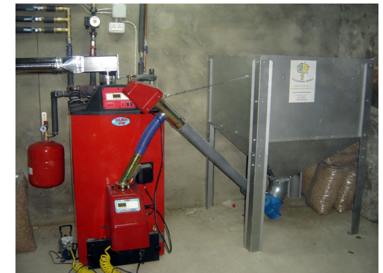
Caldera de Biomasa de pellets
