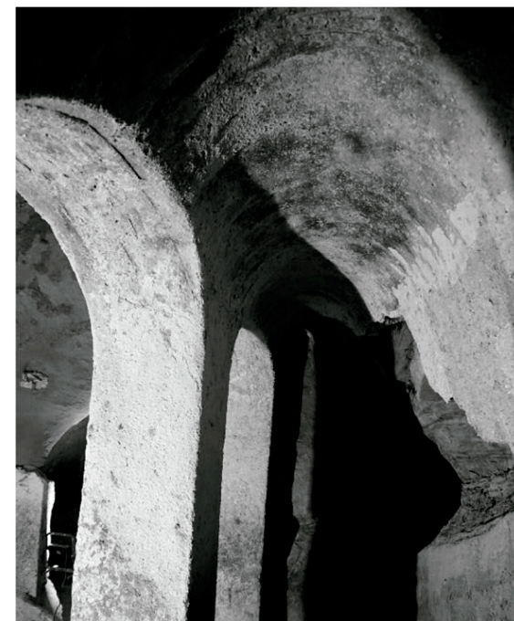
[17] Cueva-bodega. Huete (Cuenca). s. XIV-XV. Detalle de arcos. Fuente: MOCHALES SOMOVILLA, C., BERNARDO SÁNCHEZ, A., ARLAN- DI RODRÍGUEZ, M. (TÚNELES Y GEOMECÁNICA), COMBA, A. (DA VINCI RESTAURO S.L.), Proyecto Ejecución. Rehabilitación de cueva-bodega en Huete (Cuenca) , Cuenca, Fundación Huete Futuro, 2018, documentación inédita facilitada por Carlos Mochales Somovilla arquitecto y Fundación Huete Futuro.
