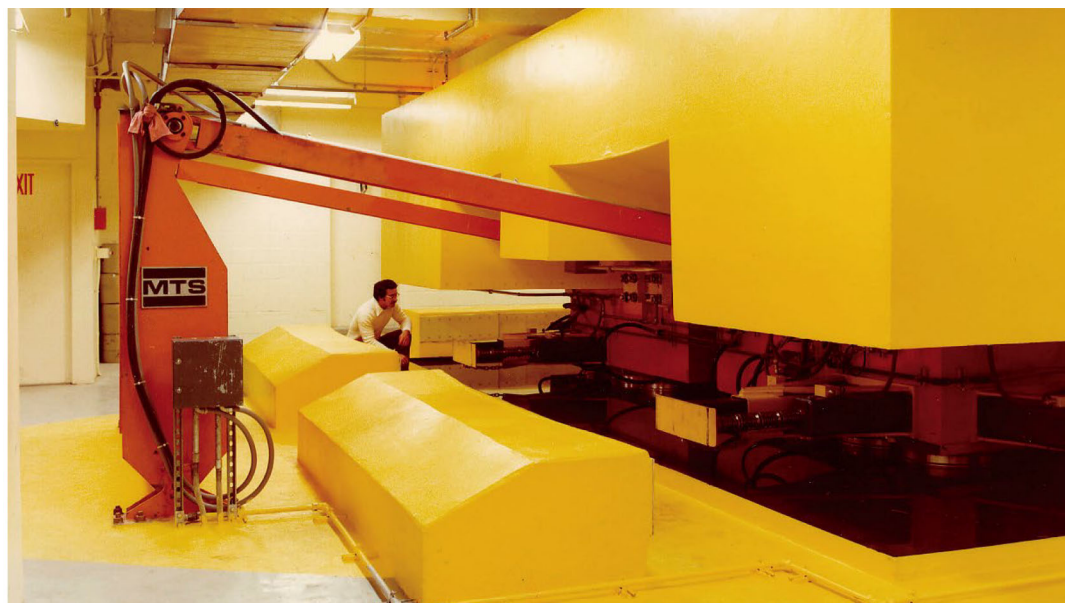
Figura 15. Amortiguador de masas hidráulico, ubicado en la coronación de la torre Citicorp.
