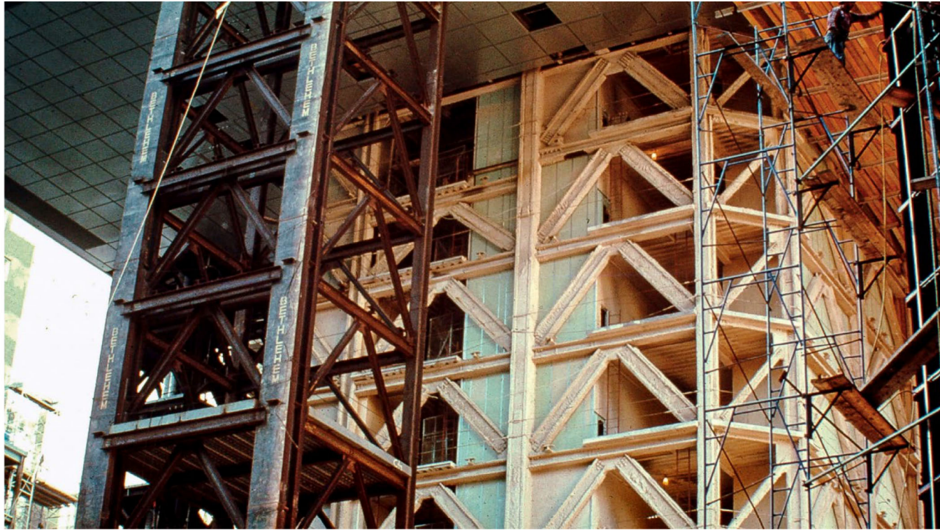
Figura 14. Detalle de los arriostramientos del núcleo en la base (en segundo plano) y de uno de los pilares en celosía del perímetro (en primer plano).
