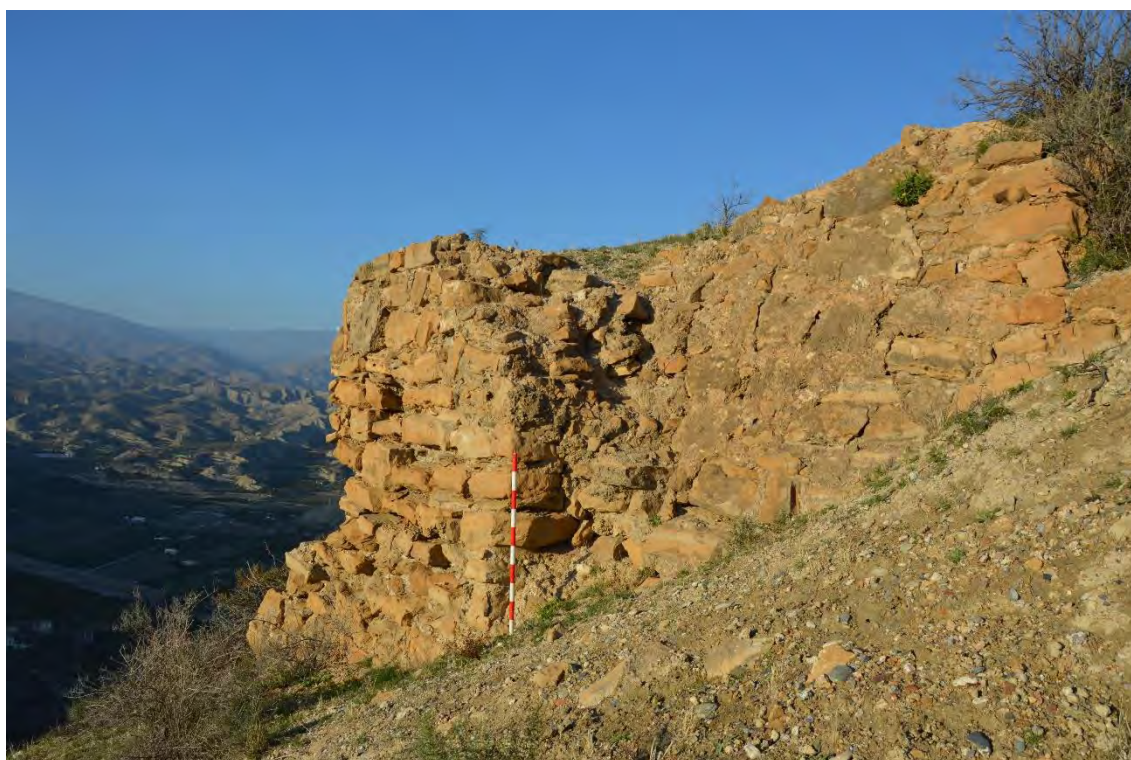
Figura 5.12. 27: Restos de la UE 56 y de la UE 57 en su extremo izquierdo, ya a plomo.
