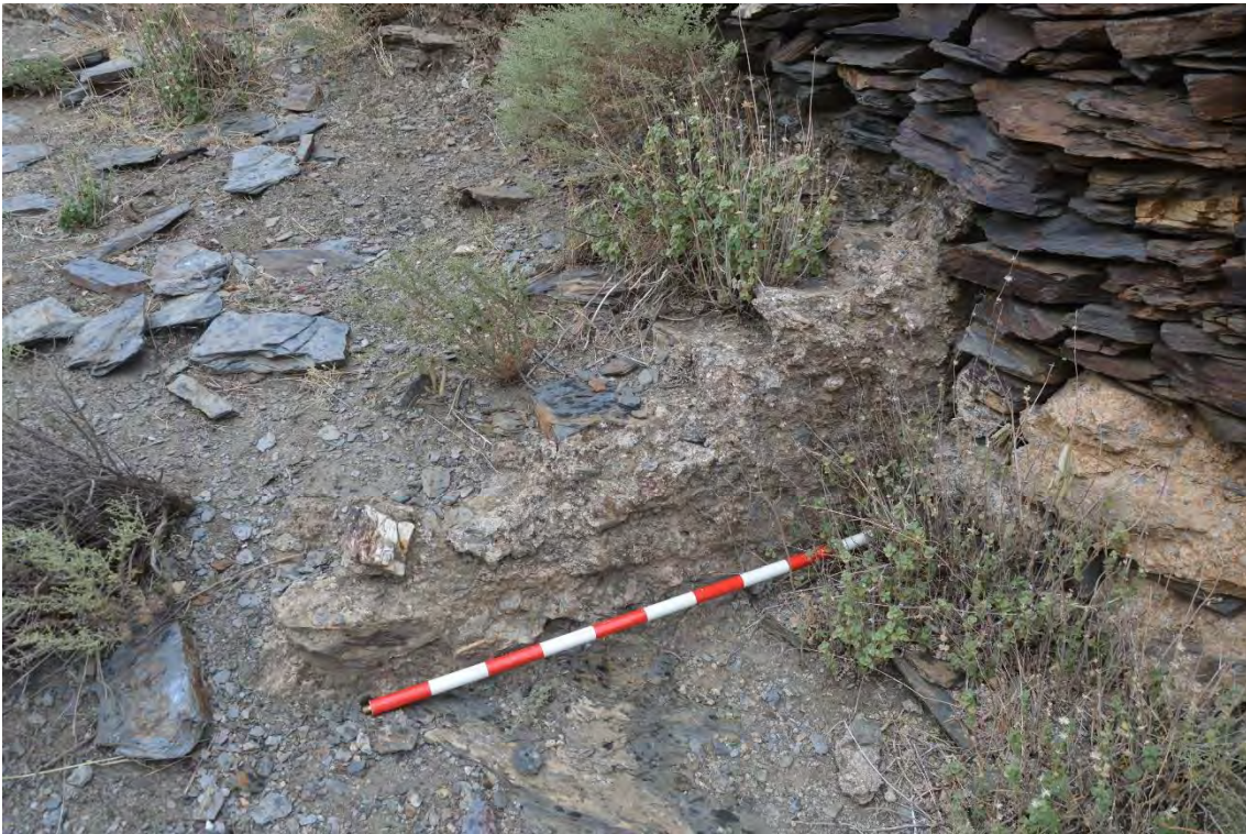
Figura. 5.13. 7: Costra de la torre de tapial calicostrado -UE 22-.
