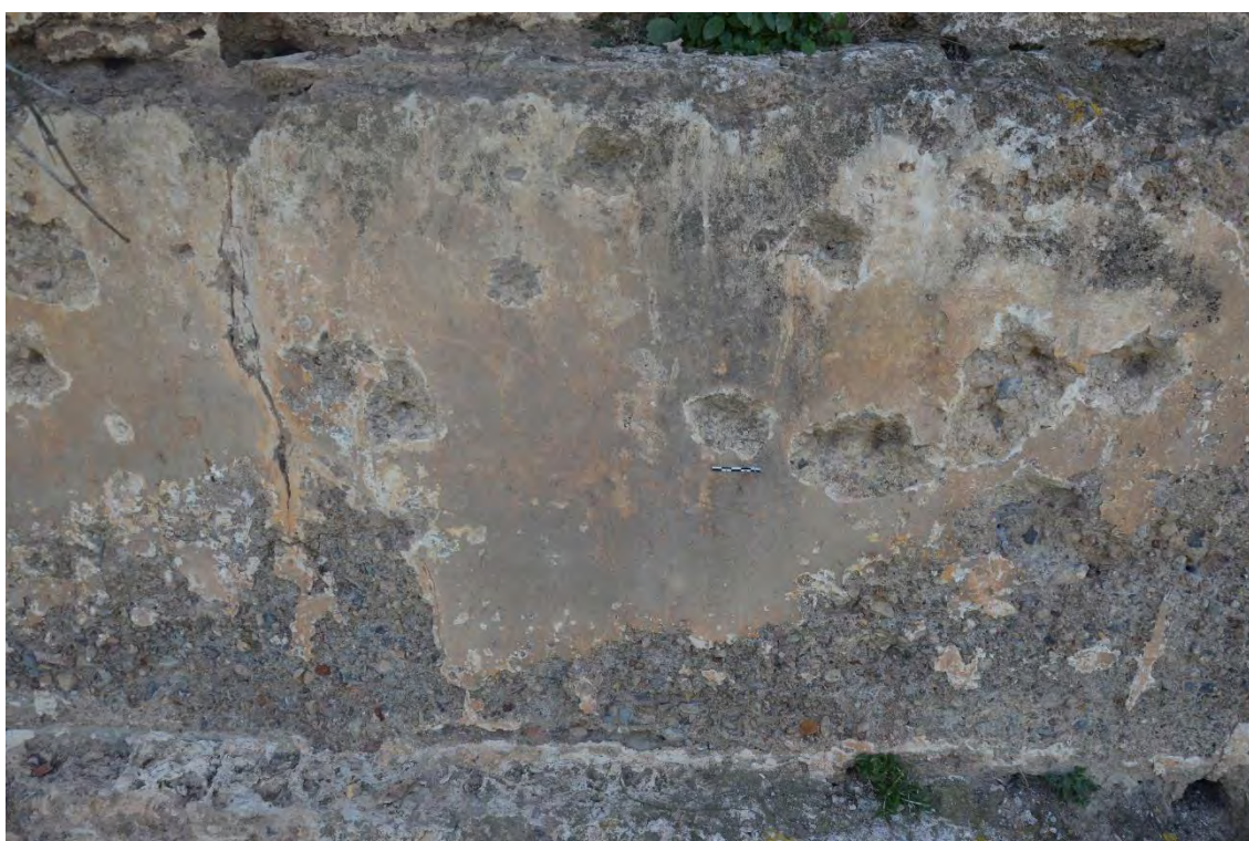
Figura 5.14. 40: Restos de impactos de bala en la cara Norte del CE 01..
