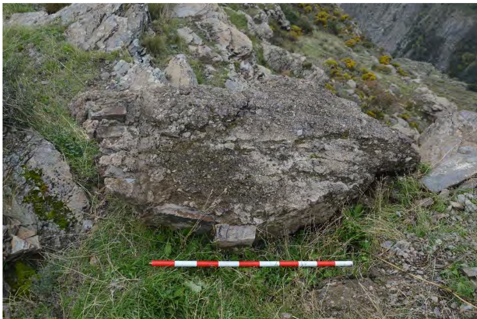
Figura 5.16 7: Restos de la UE 12 caída en la torre CE 01.
