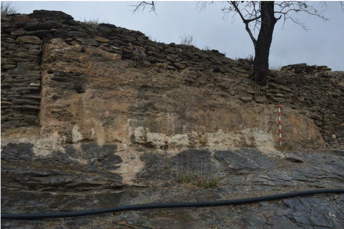
Figura. 5.13. 10: Torre de tapial calicostrado de calicanto del frente Sur de la fortaleza -UE 27-.
