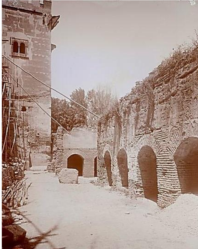
APAG. F-158. Torres Molina. Primer tercio del siglo XX. Trabajos de consolidación del paño de muralla junto a la Torre de los Picos.
