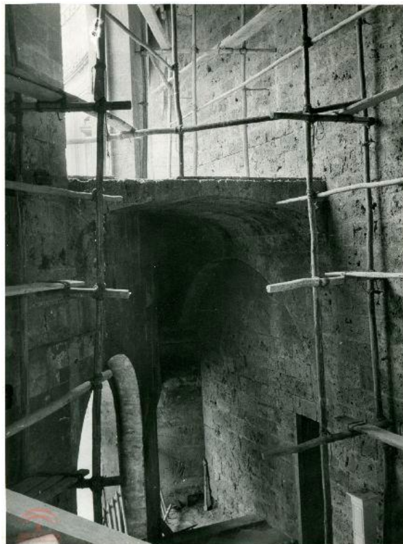
APAG. F-207220. Torres Molina, Manuel. Palacio de Carlos V. Construcción de la escalera oeste del patio. 1950-1960.
