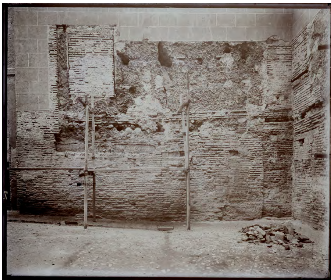
Fig.391 Obras en la Alcazaba. Ca. 1885. (Archivo del Patronato de la Alhambra y el Generalife)
