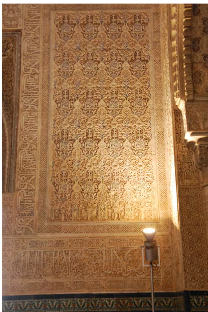
Fig. 276. Paños de yeserías reintegrados en el muro N E de la Qubba al-Garbiyya (Fotografía Francisco serrano).
