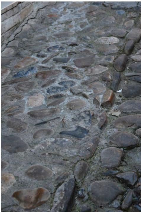
Fig.8.- Inclinación de pavimento. (Fotografía. Francisco Serrano)
