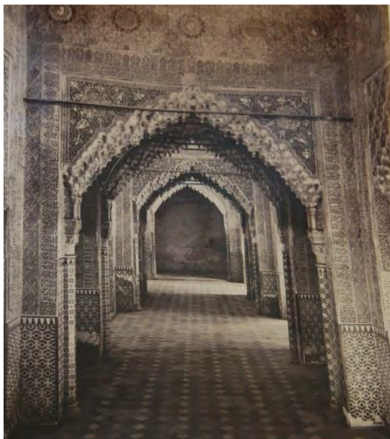
Fig. 295. Deterioros por humedades en los zócalos de la sala de los Reyes. (García Ayola 1875 ca. Archivo de la Casa de los Tiros).
