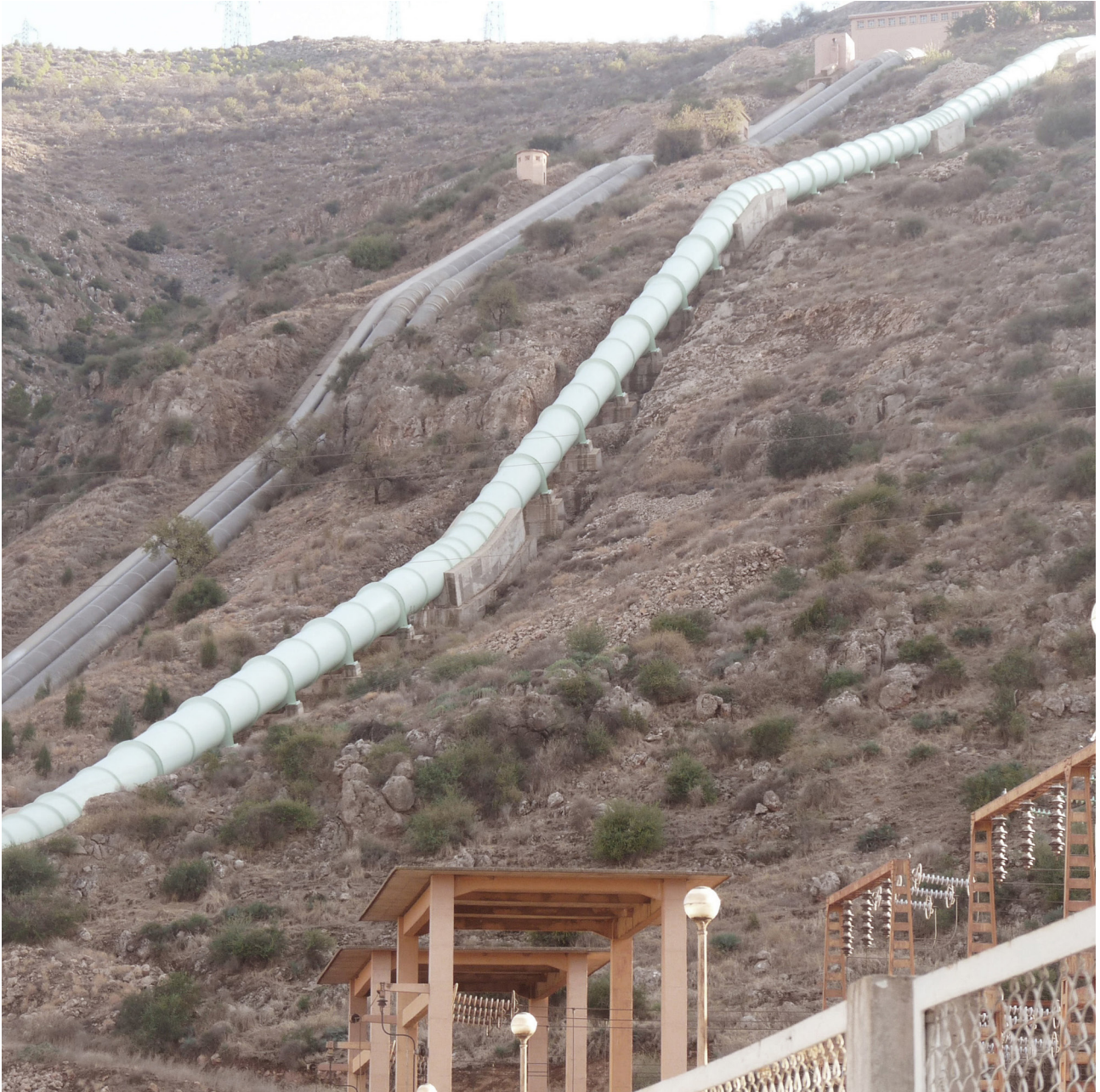
F.20.- Conductos de la estación de energía de Afourer.
