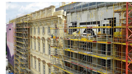
Fig 35. Fachada del Humboldt Forum en construcción, julio de 2017. Autor: Professor Ludwig (Wikimedia Commons)
