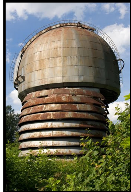
Instalación en metal abandonada
