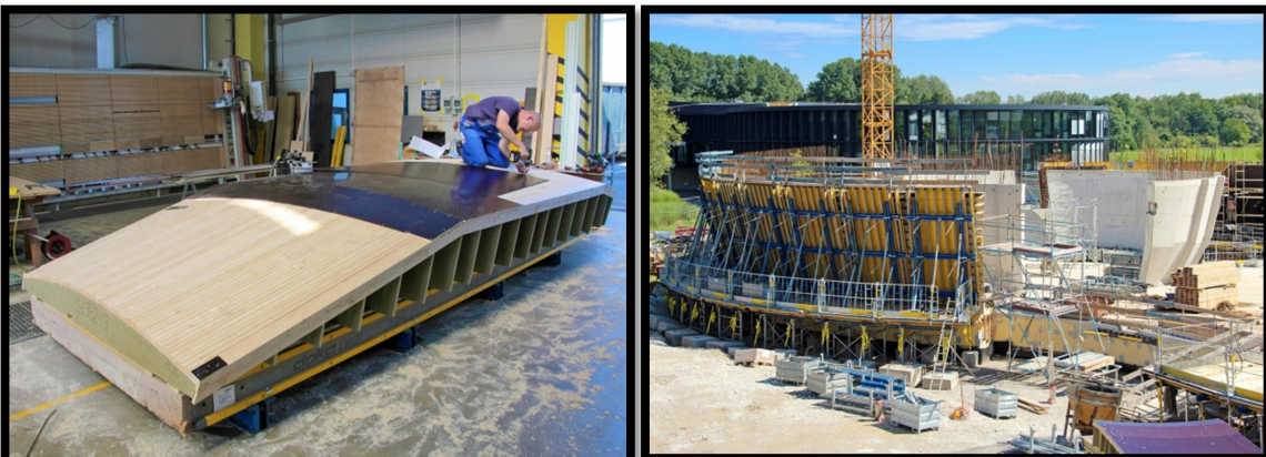
Placa de encofrado en montaje en el taller. Estructura en construcción con las placas de encofrado.
