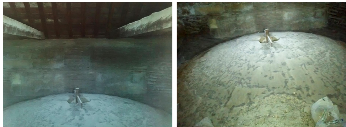
Figura 43: Vistas del extradós de una de las cúpulas laterales a través del respiradero de la cubierta. Fuente: Elab. propia.
