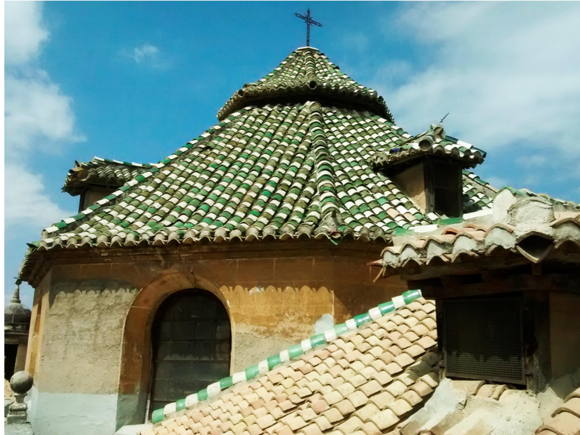
Figura 47: Muros exteriores y cubierta vidriada de la cúpula principal. Fuente: Elaboración propia.
