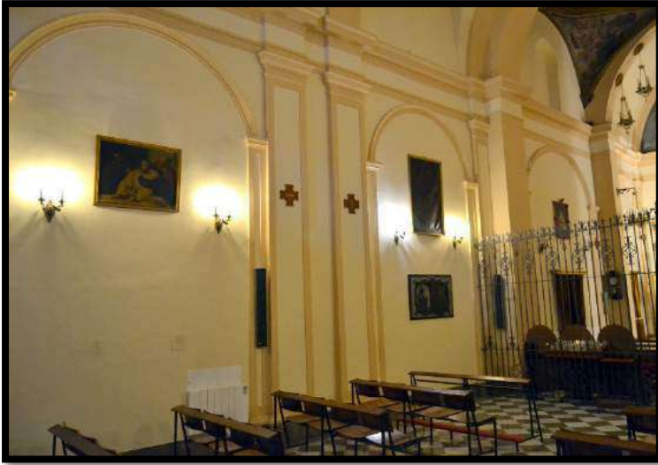
Fig.492. Muro del Evangelio cuyos arcos daban acceso a la nave colateral decimonónica, en que se encontraban las capillas de las Misericordias, de la Aurora, del Buen Consejo y de San Francisco Caracciolo. Foto: autor.
