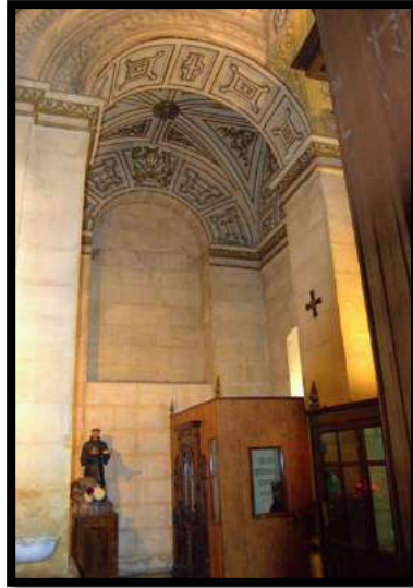
Fig.195. Estado actual de la antigua Capilla de la Virgen de Belén. Foto: autor.
