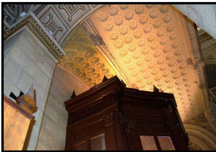
Fig.174. Bóveda escarzana de sustentación del primitivo pasillo de las tribunas y ampliación posterior. Foto: autor.
