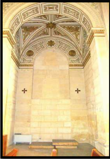
Fig.194. Estado actual de la antigua Capilla de la Sagrada Familia. Foto: autor.
