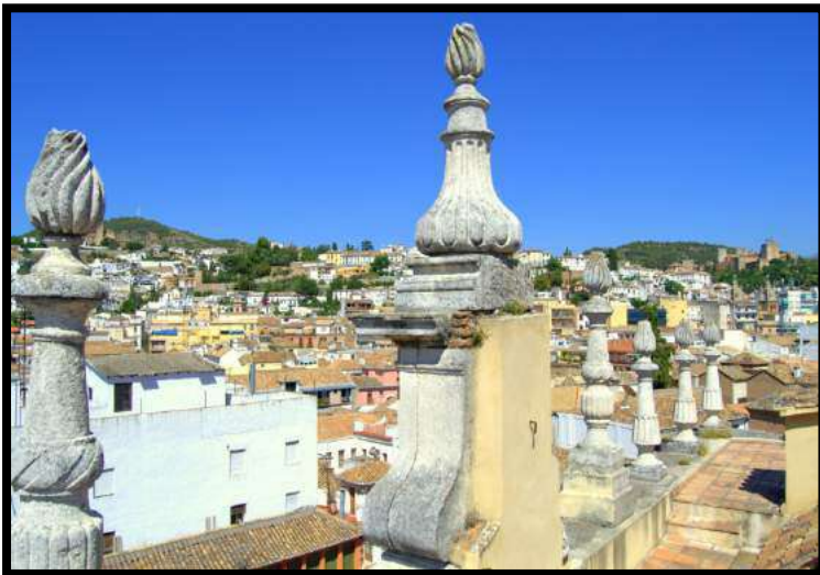
Fig.231. Estado actual del remate adintelado y terrazas del Santuario del Perpetuo Socorro . Foto: autor.
