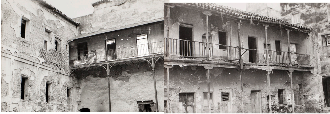
Ilustración 12. Frentes del patio de los Marqueses de la Algaba en el momento de la intervención de Manzano. (IAPH , BECERRA FONDO 26-85-05).
