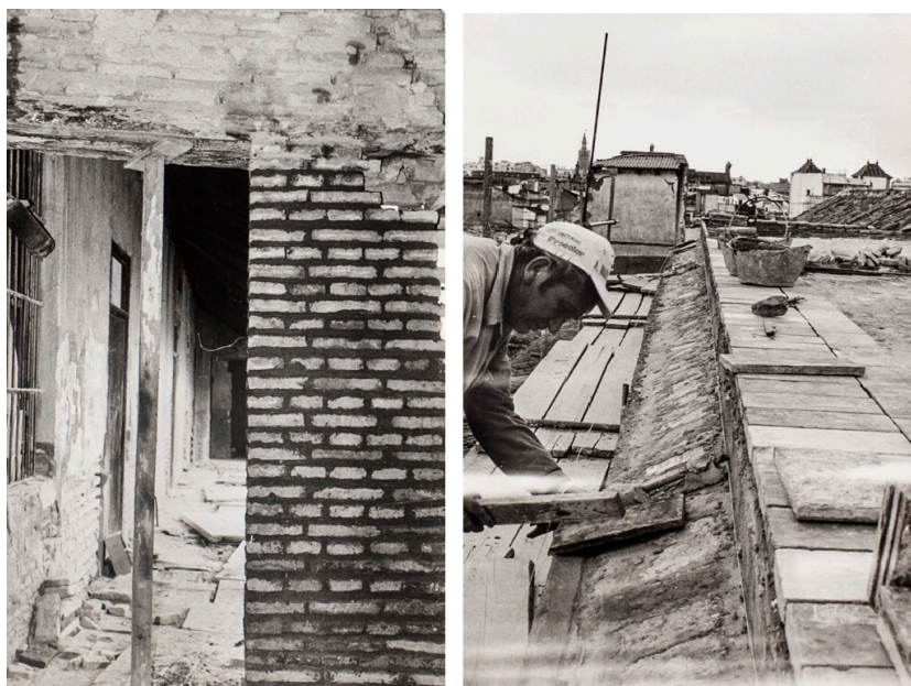
Ilustración 13. Obras de consolidación en muros y cerramiento de cubiertas (IAPH, BECERRA FONDO, 10 17 03 y 10, 21, 03).
