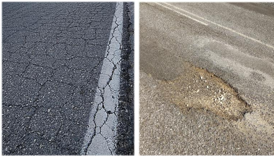
Figura 6. Ejemplo de problemas de fisuración, deformaciones y falta de cohesión en mezclas bituminosas de vías secundarias.
