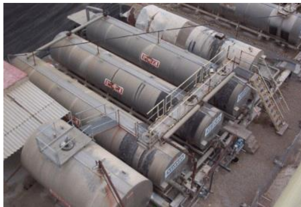
Figura 26. Tanques de almacenamiento de betunes en planta de fabricación de mezclas.
