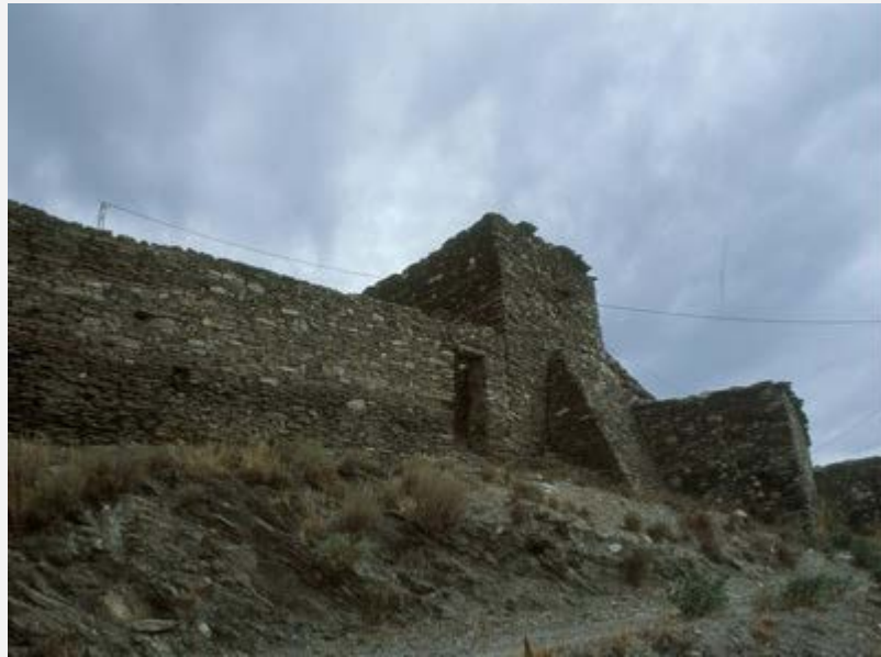
Pared reforzada con contrafuerte en Rambla Encira, Nacimiento.
