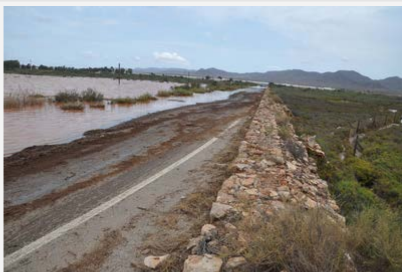
Muro para defender a las Salinas de Cabo de Gata de inundaciones.
