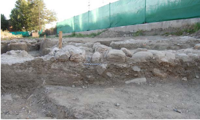
Ilustración 33. Detalle del muro correspondiente a la UE 1054, con pérdida del encofrado.
