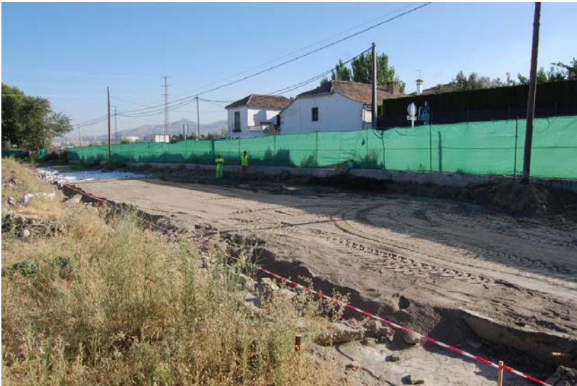
Ilustraciones 56 y 57. Cubrición con geotextil y arena a excepción de la zona donde se practicará la zanja para introducir el saneamiento
