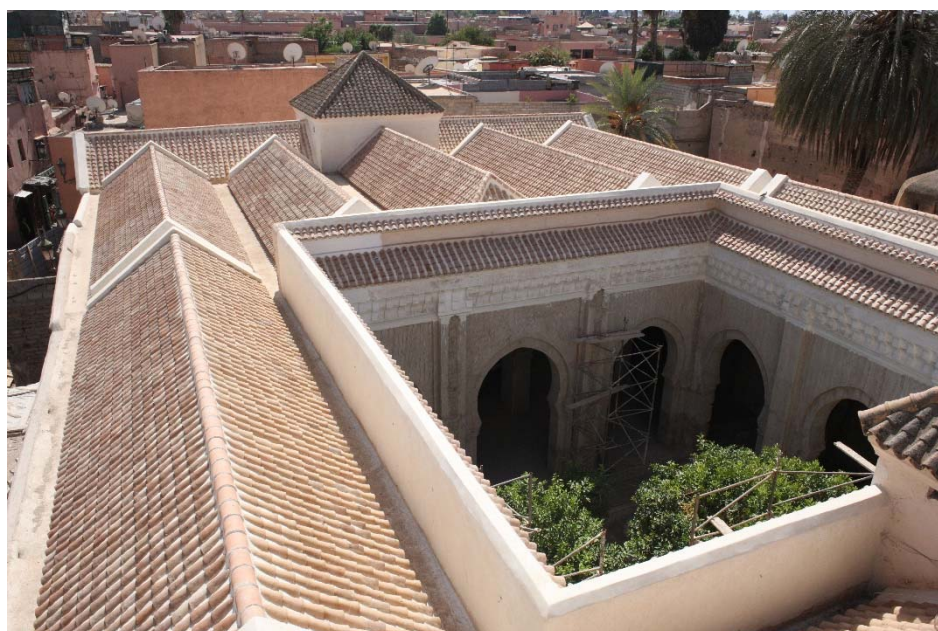
Figura 208. Zawiya de Sīdī al-Ŷazūlī. Vista de las cubiertas de la mezquita desde el alminar.
