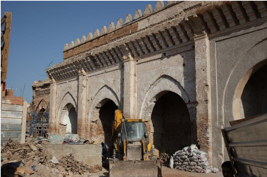
Figura 304. Mezquita de la Qaşba. Frente septentrional durante las obras de 2012. Secuencia de vanos (A. Almagro).
