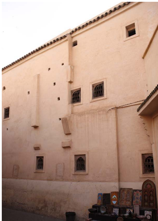
Arriba. Figura 153. Madraza Ibn Yūsuf. Fachada occidental. En medio. Figura 154. Madraza Ibn Yūsuf. Fachada septentrional. Debajo. Figura 155. Fachada occidental. Discontinuidad del muro y restos de arcos transversales.
