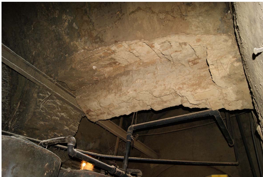
Figura 91. Complejo de al-Muwāssīn. Hammām . Rotura del muro que separaba la sala fría y la templada.
