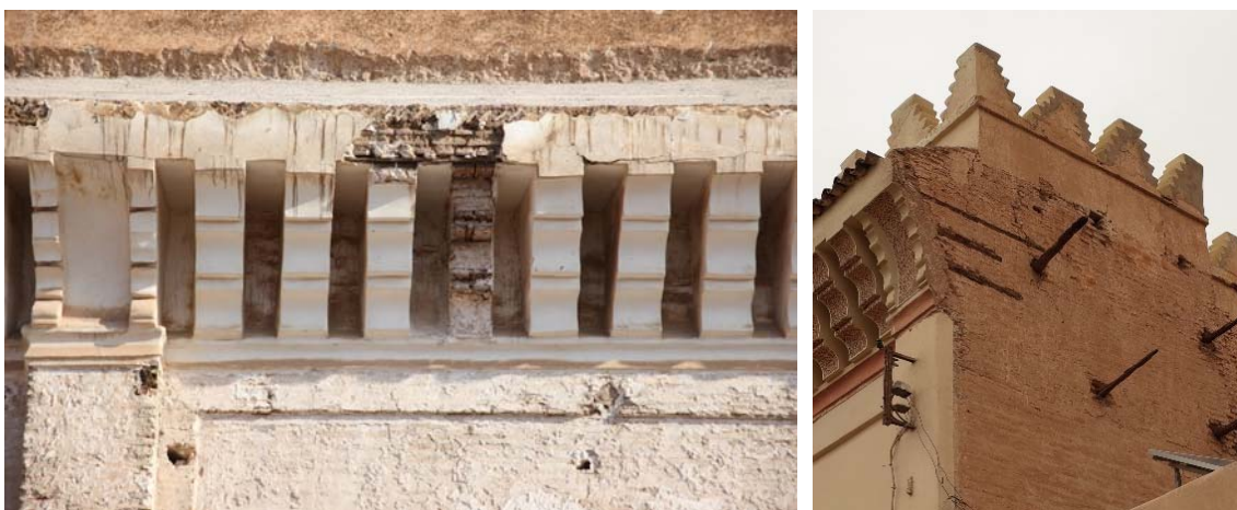
Figura 307. Mezquita de la Qasba. Frente septentrional durante las obras de 2012. Detalle de cornisa (A. Almagro).
