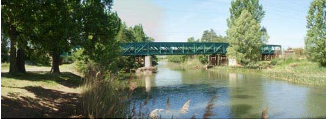
Ilustración 5. Panorámica ampliada del puente sobre el Carrión, ubicado muy cerca del núcleo urbano de Palencia
