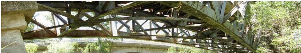
Link 6. Imagen panorámica de la celosía de arriestrado inferior en el puente sobre el Riaza
