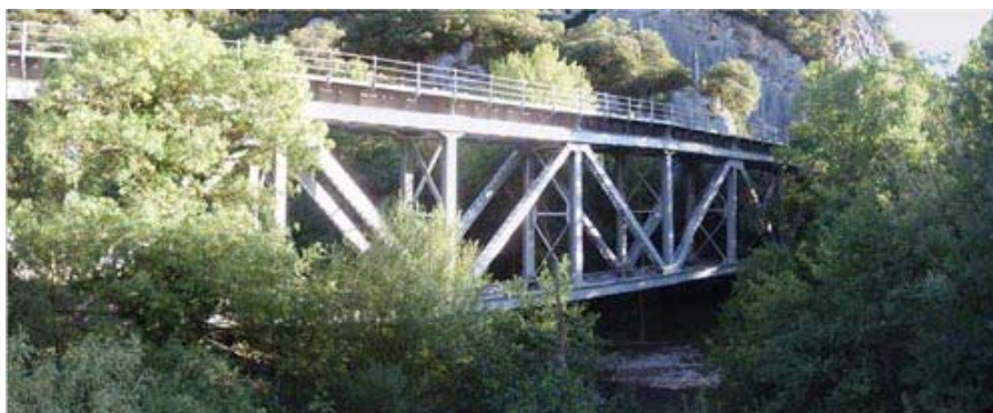
Ilustración 8. Celosía Warren en Trespaderne, Burgos. La vegetación tapa una visión completa del puente, 90 años después de su entrada en servicio
