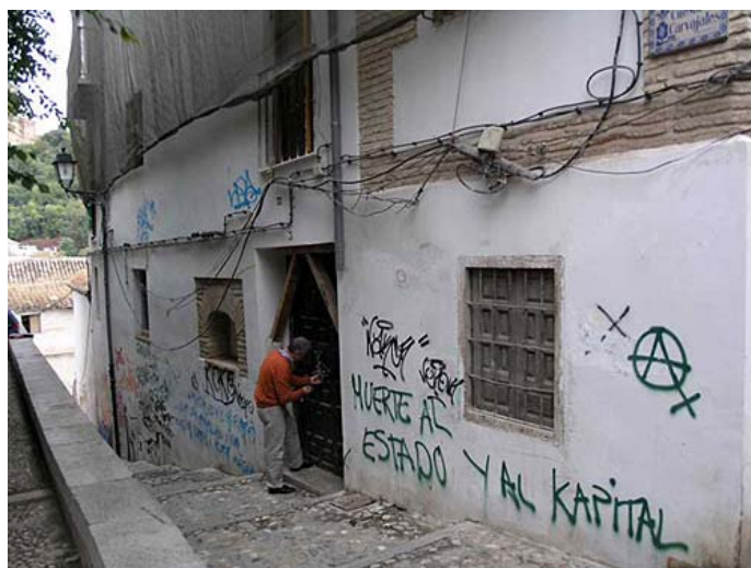
Ilustración 4. Casa de Cuesta de Carvajales 3 (Albaicín, Granada). Noviembre 2006. Pintadas y deterioro general del edificio. Responsabilidad social y del propietario. Proceso de rehabilitación impulsado por el ARC del Bajo Albaicín.
