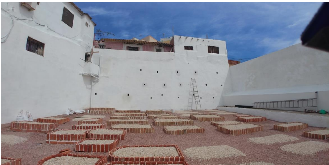
Cementerio de San Carlos en su proceso de rehabilitación. Cortesía de Mordejay Guahnich.
