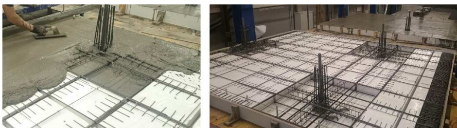
Figura 6.14. Hormigonado del forjado del espécimen. Izq.: Vertido del hormigón. Der.: Estado previo y posterior al vertido del hormigón.
