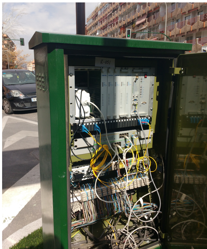
Figura 5.38 Instalación provisional del nodo sensor en entornos urbanos, ubicado dentro de los armarios de conexiones.
