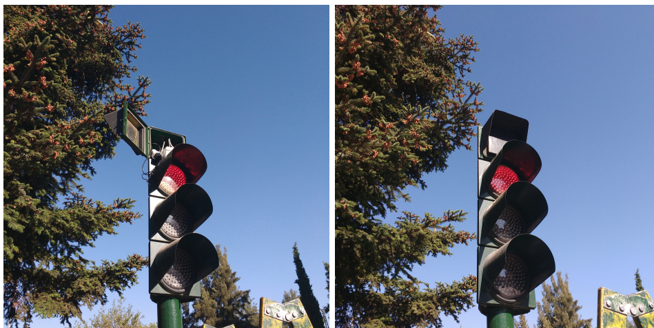
Figura 5.39 Instalación del nodo de monitorización en el interior de un semáforo en un escenario urbano, el frontal de la caja es de plástico, por lo que permite la recepción de las antenas sin interferencias, a la vez que el cuerpo metálico apantalla todo el tráfico que no se encuentre delante del semáforo.
