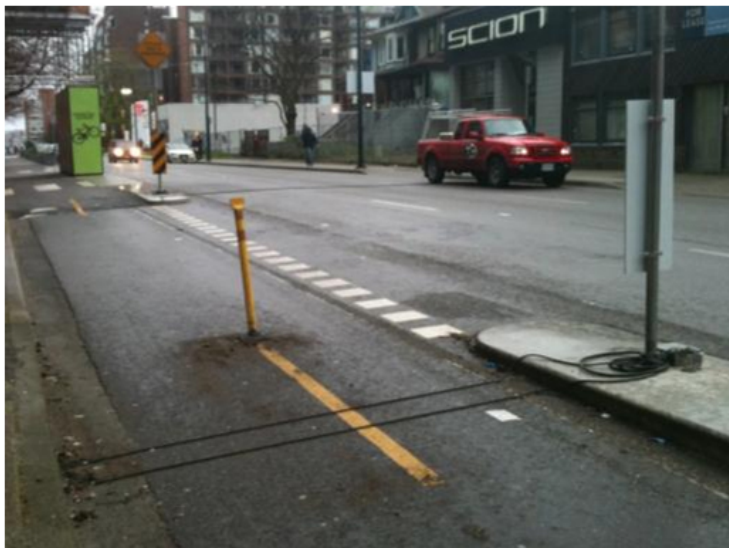
Figura 3.7 Fotografía de un tubo neumático instalado en la calzada. Fuente: Jean-Francois Rheault, Eco-Counter.
