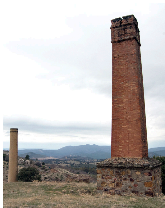
Imagen 352: Chimeneas de Santo Tomás. Se observa la grieta existente en la parte superior de la chimenea de sección cuadrada. Autoría propia.
