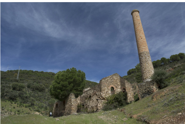
Imagen 356: La Botella. Igual que ocurre en otros inmuebles, la vegetación crece en el interior de los edificios impidiendo el acceso y deteriorando la estructura. Autoría propia.
