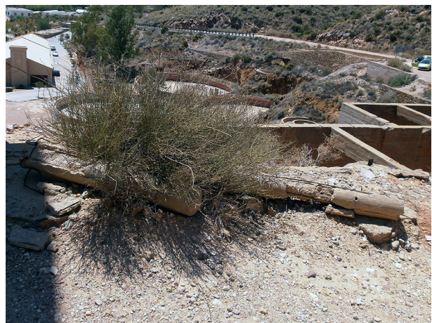
Imagen 72: Derrumbes e inexistencia de balizas en las inmediaciones del sendero. Autoría propia.
