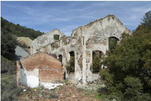
Imágenes 343 y 344: Vistas delantera y trasera de la casa de máquinas y calderas del Pozo San Guillermo. El pozo se oculta tras la maleza. Autoría propia.
