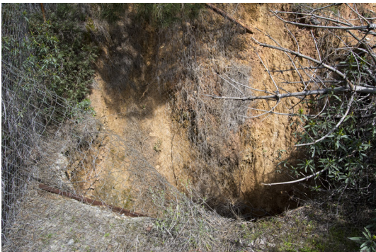
Imagen 345: Hundimiento del camino de acceso a San Guillermo. Autoría propia.
