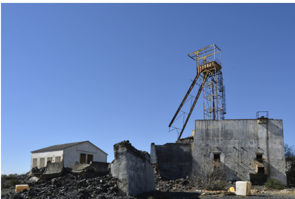
Imagen 177: Restos del Pozo 3. Como se puede observar, la falta de protección ha favorecido que se cometan actos vandálicos contra la cabria, a la que se ha cortado casi la mitad de uno de los anclajes. Autoría propia
